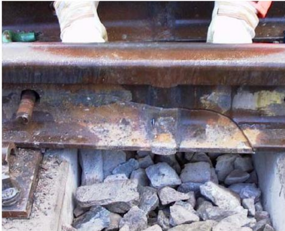
شکل ۳ - مثال نوعی از ترک طولی در جوش ترمیم
