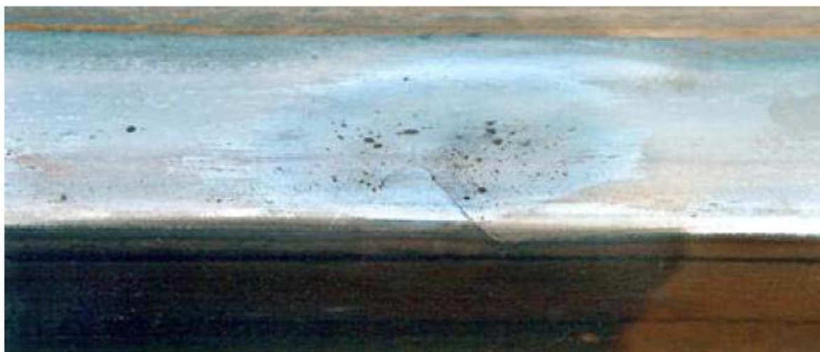
شکل ۱۴ - مثال نوعی ترک های V شکل در سطح رویی تاج
