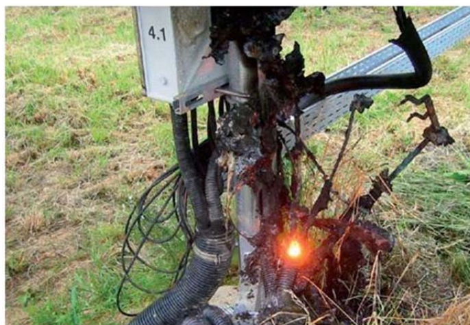
شکل (۳-۱۲): وقوع آتش‌سوزی در اثر عدم بکارگیری سیستم حفاظت خطای زمین
