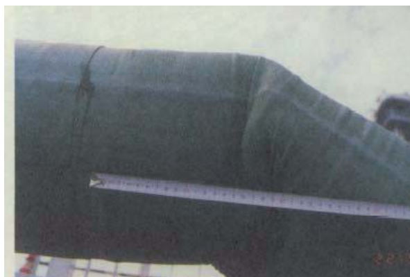
شکل ۷-۱ چین و چروک و کماتش لوله خم
