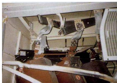
شکل ۹-۸ آسیب دیدگی قسمت‌های اطراف ترانسفورماتور
