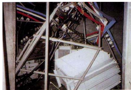
شکل ۹-۷ واژگونی مبدل (ترانسفورماتور) در تأسیسات برقی روباز
