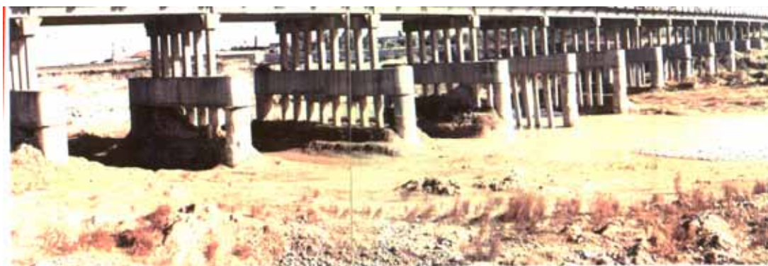
تصویر ۱-۲- آب‌شستگی پایه‌های پل رودخانه تالار در اثر برداشت شن و ماسه از رودخانه [۴]
