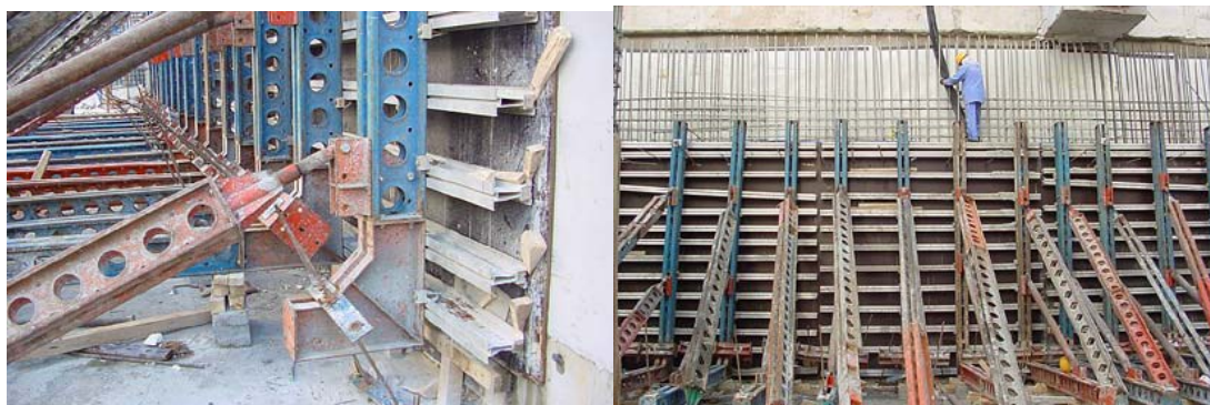
شکل ۷-۱ لزوم دقت در قالب‌بندی و درزبندی و همچنین افزایش پشت‌بند و مهارهای لازم، در بتن‌ریزی با SCC
