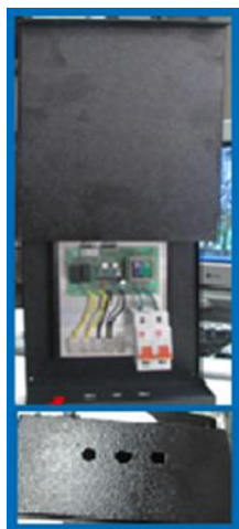
شکل ۲-۱۸: کابینت کنترلر چشمک‌زن برقی
