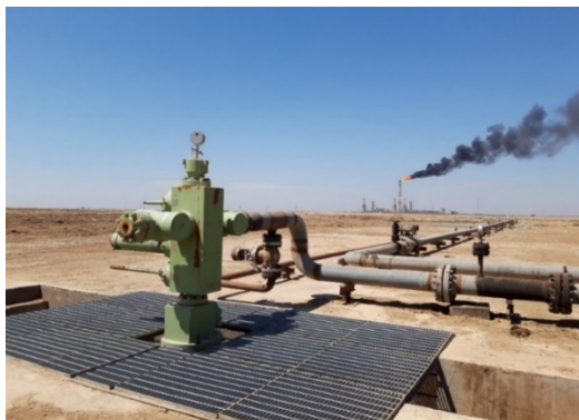
شکل ۳-۳ محوطه سلر و تجهیزات سرچاهی
