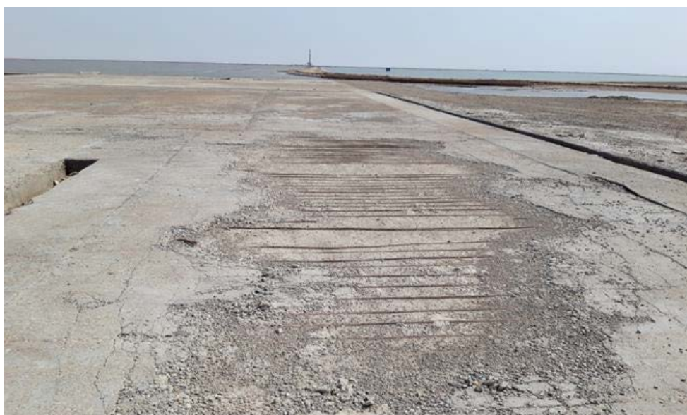
شکل ۳-۵ از بین رفتن پوشش بتنی روسازی محوطه سله در میدان نفتی آزادگان جنوبی
