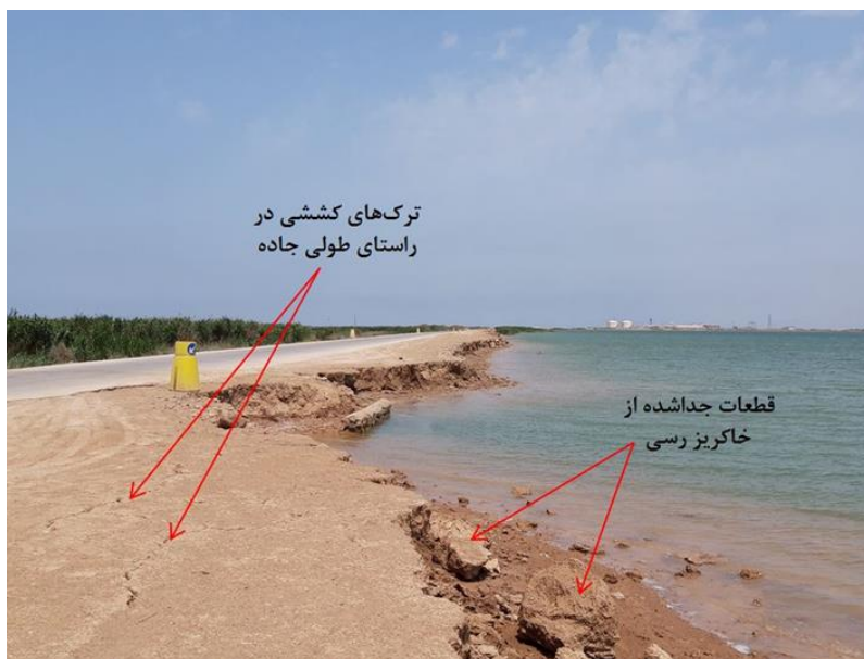
شکل ۴-۷ وقوع ترک‌های کششی طولی در سطح خاکریز تعریض شده جاده اکتشاف
