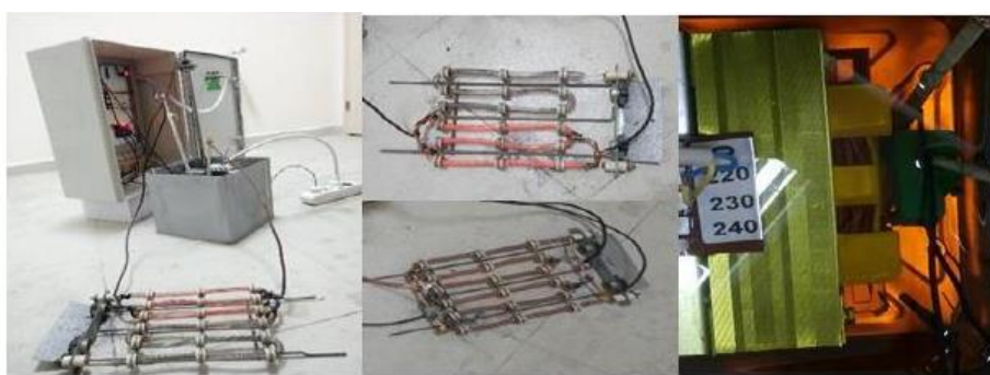
شکل ۲۸-۷: سیستم پایش ترانسفورماتور و تجهیزات تست
