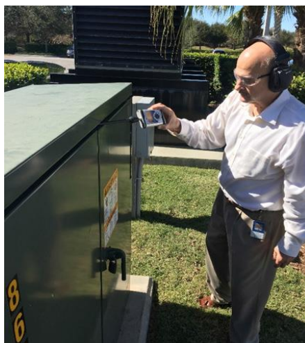
شکل ۴-۲۴: بکارگیری سیستم فراصوت با قابلیت نصب بر روی ترانسفورماتور
