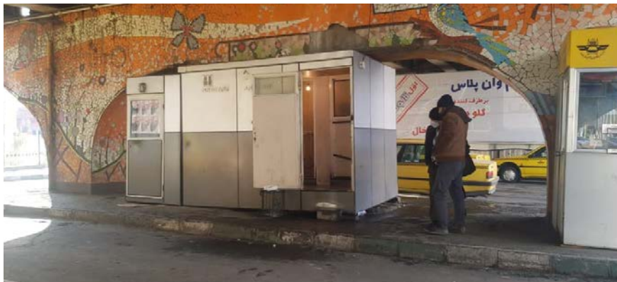
شکل پ-۷: استقرار سرویس بهداشتی عمومی در موقعیت‌های نامناسب و یا ناامن در سرویس‌های عمومی بازدید شده - عرض کم ورودی کابین سرویس‌های بهداشتی عمومی، وجود اختلاف سطح و استاندارد نبودن ابعاد سرویس بهداشتی ویژه معلولین (شکل پ-۸).
