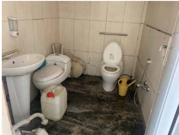
شکل پ-۱۶: عدم رعایت ضوابط در اجرای سرویس بهداشتی معلولین
