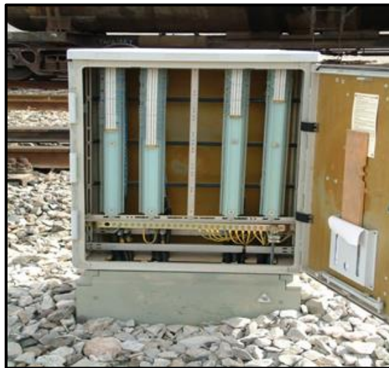
شکل ۵-۶- نمایشی از جعبه DC نصب شده
