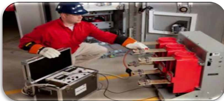
شکل ۵-۹: انجام به‌موقع سرویس‌های دوره‌ای تجهیزات تابلو برق
