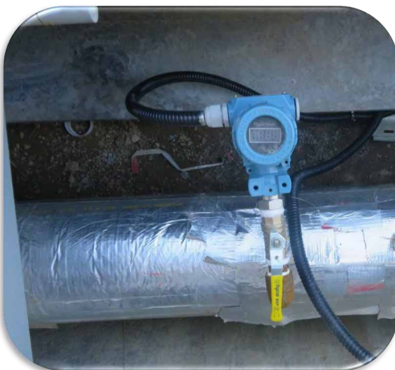
شکل ۵-۶۷: حسگر فشار خط لوله آتش‌نشانی
