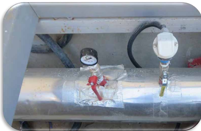
شکل ۵-۶۸: حسگر دمای خط لوله آتش‌نشانی
