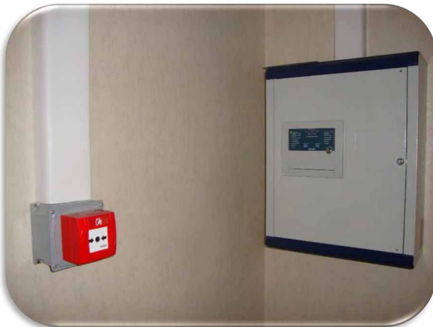
شکل ۵-۲۴: پانل سیستم اعلام حریق
