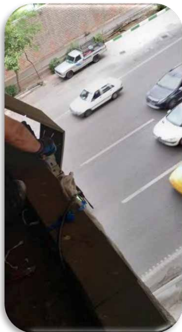
شکل ۵-۵۰: سینی کابل نصب‌شده در بر روی سازه پل
