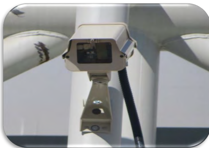
شکل ۵-۶۵: حسگر ترافیکی یا تردد شمار نصب‌شده در ارتفاع
