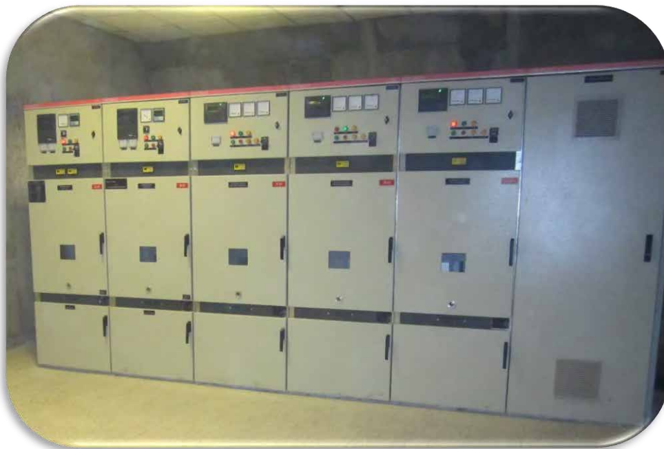
شکل ۵-۱: تابلوی ایستاده توزیع برق سه فاز فشار متوسط
