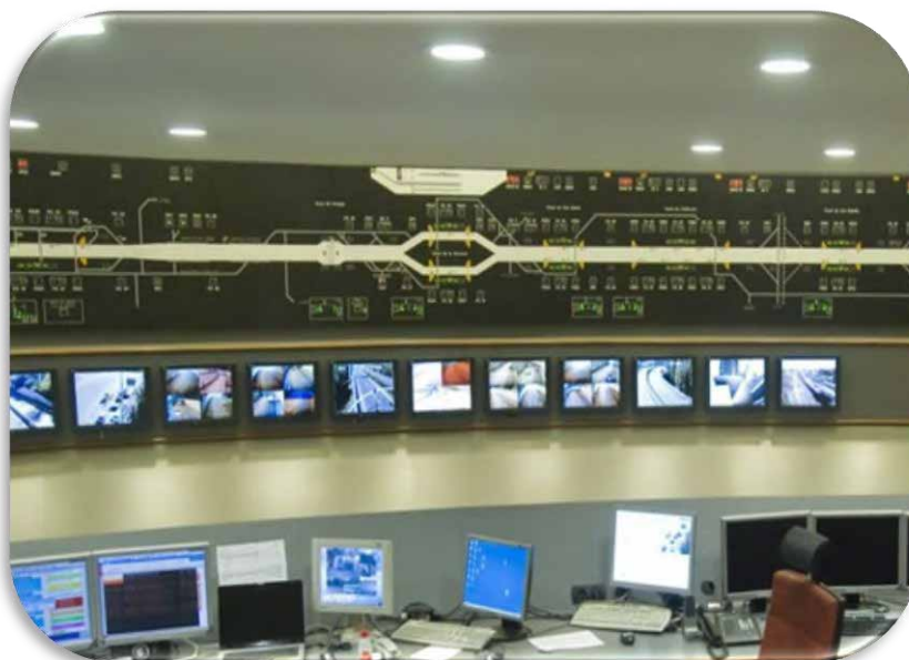
شکل ۵-۴۷: نمونه یک اتاق کنترل
