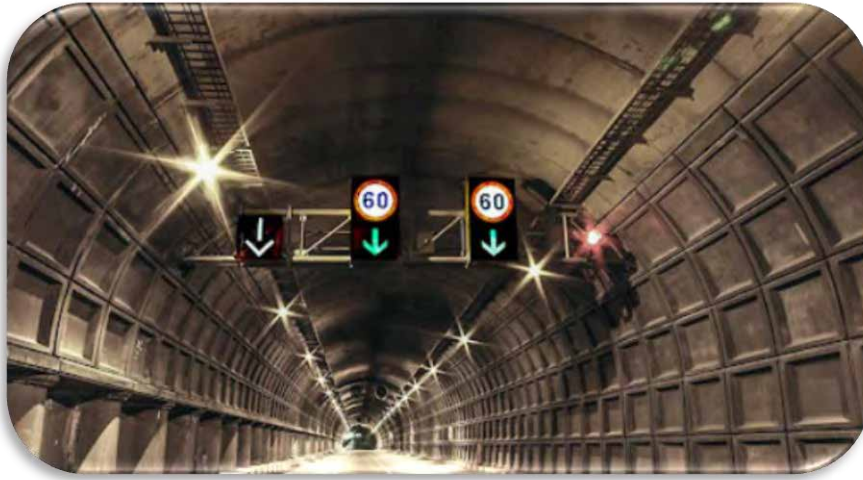
شکل ۴-۹: نمونه‌هایی از تابلوهای متغیر خبری داخل تونل
