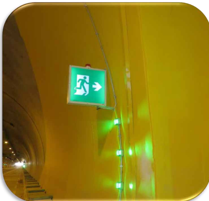
شکل ۵-۵۹: تابلوی نورانی جهت نمای درب خروج اضطراری
