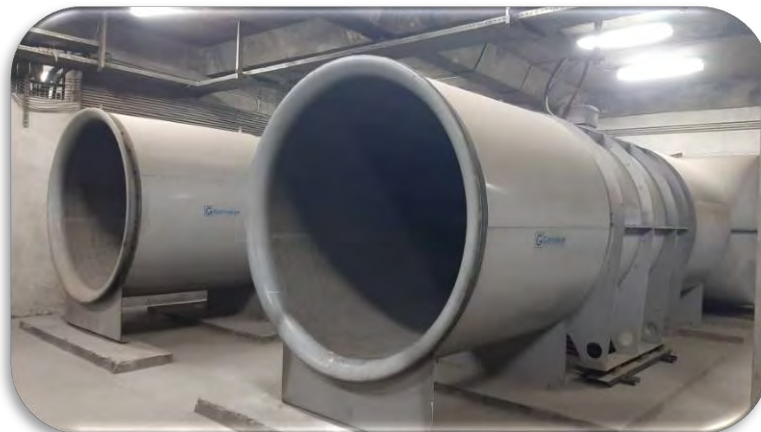
شکل ۵-۷۰: فن سیستم تهویه عرضی
