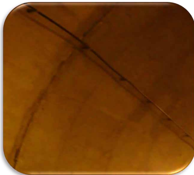
شکل ۵-۶۴: کابل سیستم رادیویی
