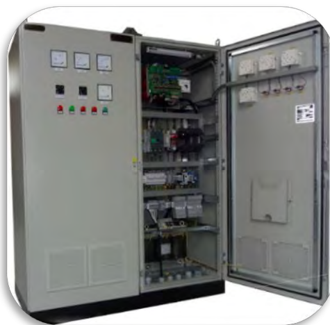
شکل ۵-۳۳: تابلوهای بانک خازنی پست‌های برق
