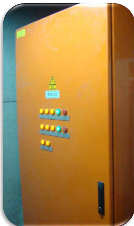
شکل ۳-۵: تابلوی ترکیبی ایستاده سه فاز توزیع برق
