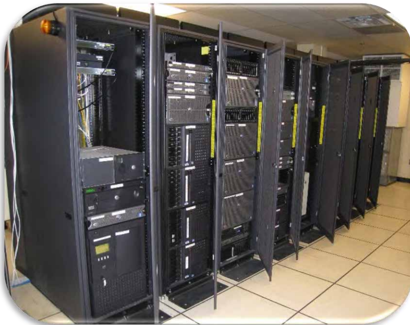
شکل ۵-۴۸: تجهیزات اتاق کنترل
