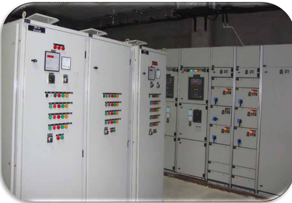
شکل ۵-۲: تابلوی ایستاده توزیع برق سه فاز فشار ضعیف
