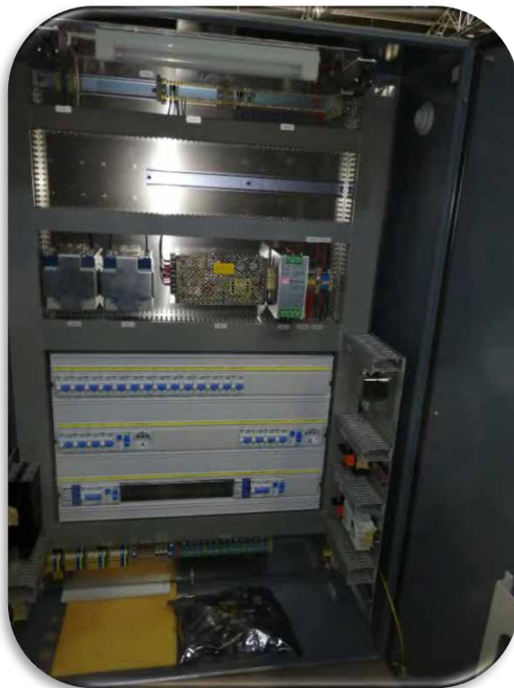
شکل ۵-۴: تابلوی دیواری سه فاز توزیع برق
