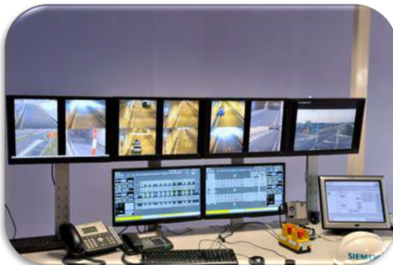
شکل ۴-۵: نمایی از یک مرکز کنترل تونل
