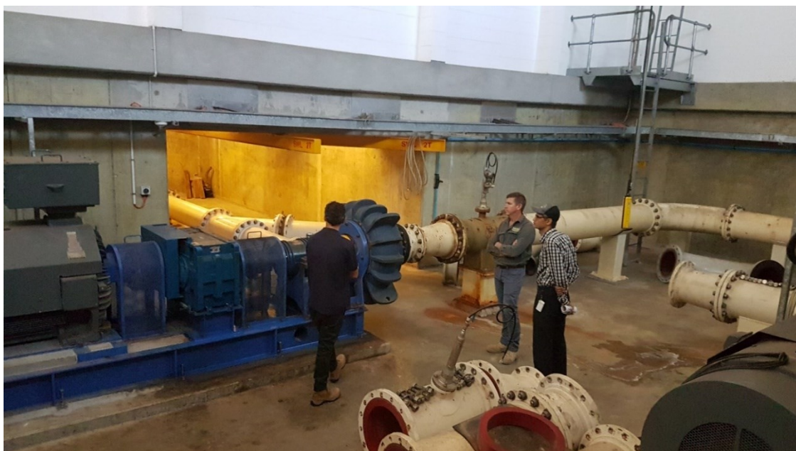
شکل ۲-۶- نمایی از داخل ساختمان پمپاژ سیستم گذردهی رسوب رودخانه توئید
