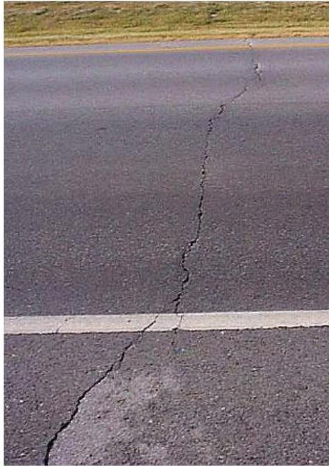
شکل ۲- ترک خوردگی عرضی
