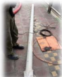
لوله پلیکا سوراخ شده
