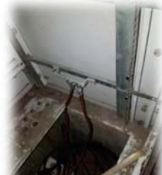
انشعاب ارت به شینه تابلو برق
