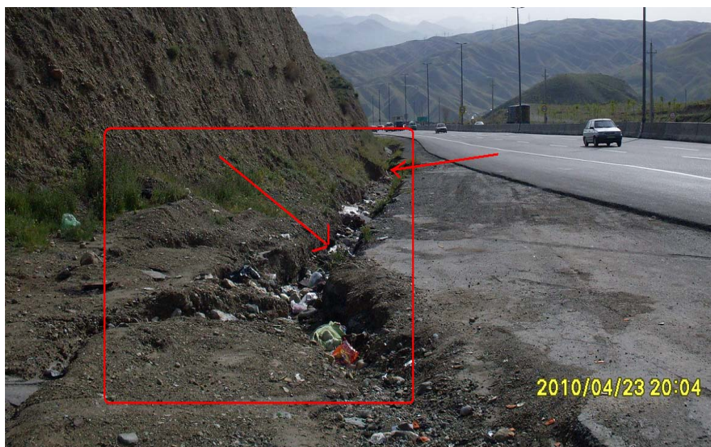
شکل پ ۷- عدم وجود کانال طولی هدایت آب که منجر به خرابی کناره راه و جسم راه می گردد (مسئله آب به جسم راه نفوذ می نماید)
