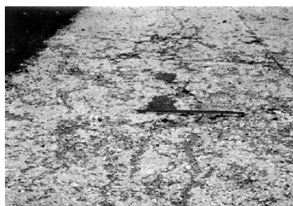
ترک‌خوردگی ریز سطحی / شن‌زدگی با شدت زیاد
