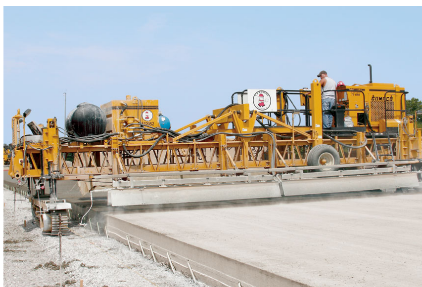
شکل ۳-۴۲- تجهیزات عمل‌آوری بتن
