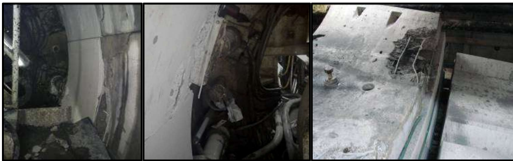
شکل ۱-۶- شکستگی شدید سگمنت‌ها در اثر عملیات پرفشار در تونل نوسود
