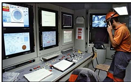
شکل ۵-۱۲- اتاق کنترل ماشین حفاری مکانیزه مجهز به سامانه پایش، پردازش، ذخیره و انتقال اطلاعات و کنترل از راه دور ماشین
