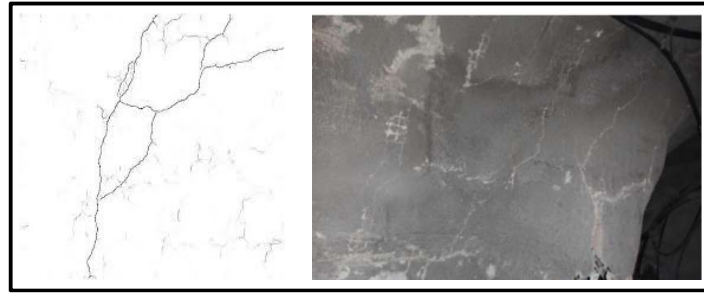
شکل ۳-۴- ترک خوردگی شاکریت تحت اثر ارتعاشات ناشی از انفجار در سنین اولیه
