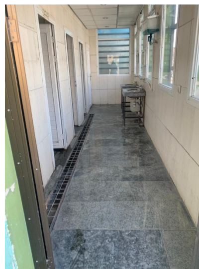
شکل پ- ۱۹: استفاده از کفسازی نامناسب و لغزنده
