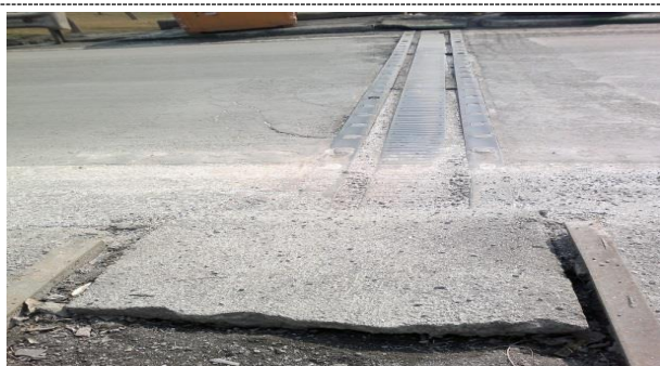
انبساط درز انبساط در پیاده‌رو و آسیب روکش پیاده‌رو در محل درز
