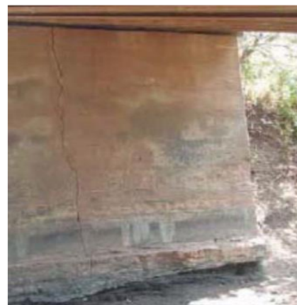
ترک قائم با عرض زیاد و آسیب‌دیدگی و آبستگی بتن پای دیوار کوله مشهود است
