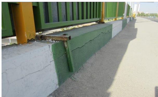
اتصال نامناسب قطعات الحاقی (تابلوه‌های تبلیغاتی، گلدان و ...) به جدول و ترک خوردگی و آسیب دیدگی جدول
