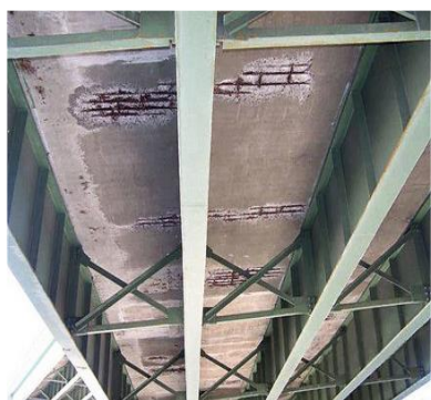
آثار نشت آب، اضمحلال بتن زیر عرشه و نمایان شدن آرماتورها مشهود است
