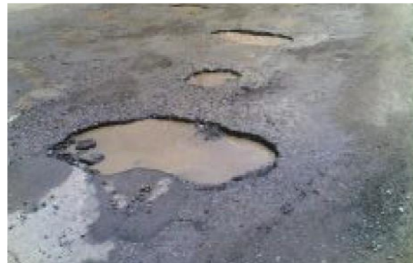
قلوه‌کن شدن آسفالت و ایجاد چاله مشهود است
