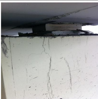
بتن پایه ترک خورده است
