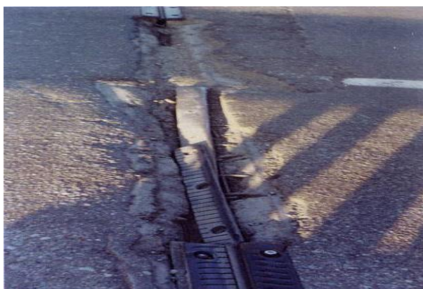
بخشی از درز (ورق رویه، لاستیک درز و بتن اطراف درز) کنده شده و از بین رفته است و ایجاد چاله نموده است
