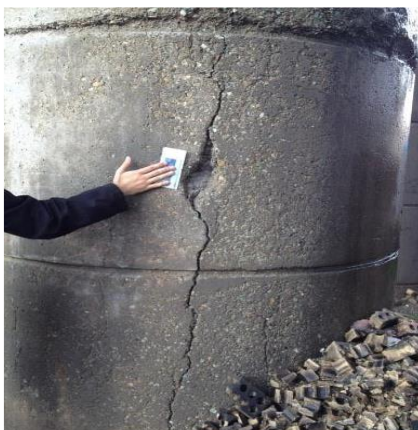
ترک با عرض زیاد و قلوه‌کن شدگی بتن پایه وجود دارد
