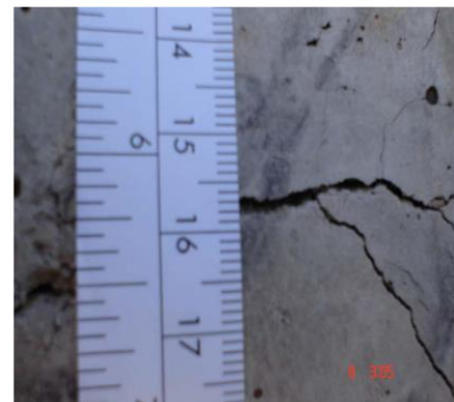
بتن ترک خورده است
