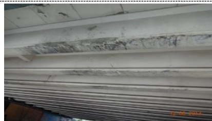
اضمحلال و ترک خوردگی بتن
