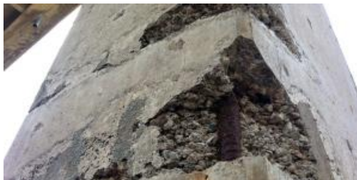
شکل ۱۹: قلوه‌کن شدن بتن
