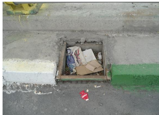
دریچه مفقود شده است مجرای زهکش مسدود شده است اجزاء زهکش زنگ‌زدگی و پوسیدگی دارند
