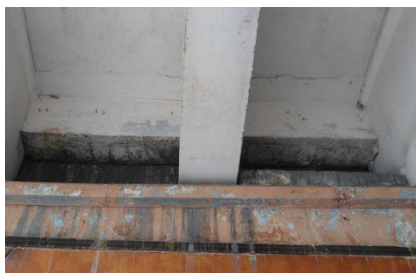
آثار نشست آب، اضمحلال بتن و ترک خوردگی انتهای دال مشهود است
