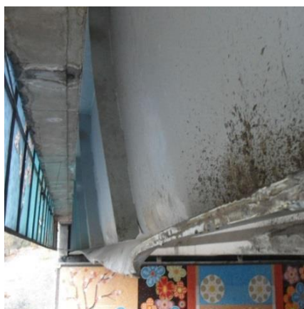
سطح مقطع تیر در اثر ضربه دچار پیچش (انحراف) شده است.
