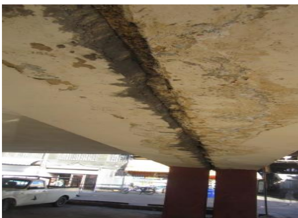
نشت در طول درز که باعث خرابی سازه شده است
