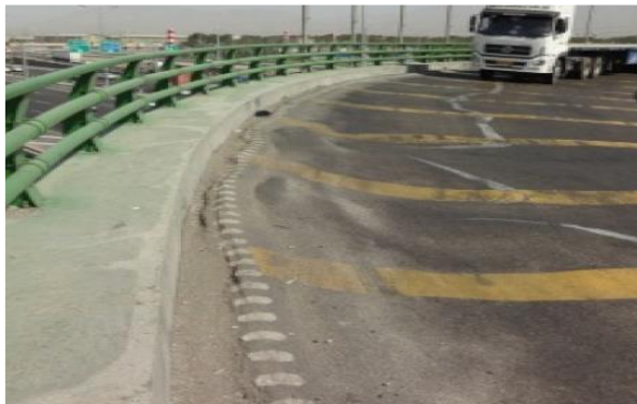
سطح ناهموار شده و ناهمواری‌ها و دست‌اندازه‌ها، باعث کاهش آسایش بهره‌برداران شده و یا حین عبور ترافیک، سازه پل دچار لرزش و ارتعاش می‌شود
