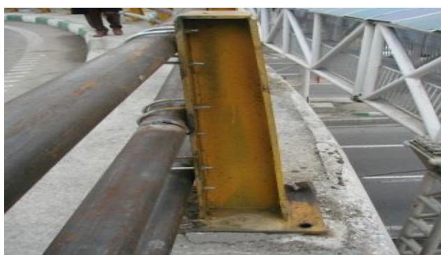
تعدادی از پیچ‌ها باز شده یا بیرون زده شده است
