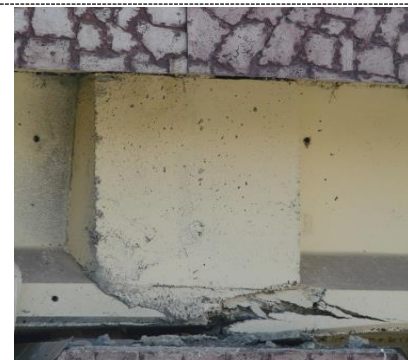
ترک خوردگی و خرد شدن بتن مشاهده می‌شود
