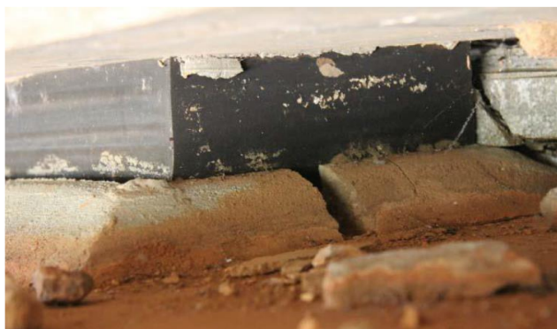
گروت زیر تکیه‌گاه دچار ترک‌خوردگی شدید شده است و شکست مالات کاملاً واضح است
