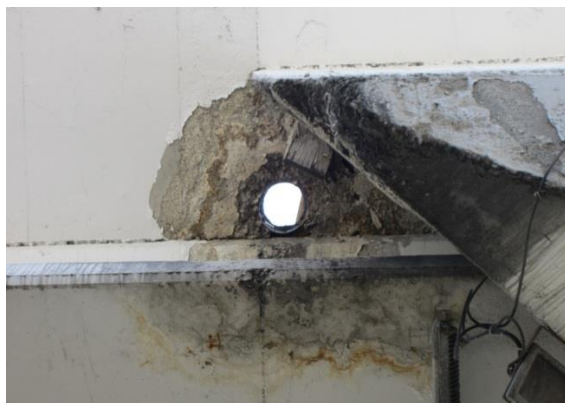
اجزاء زهکش وجود ندارند و نفوذ آب باعث قلوه‌کن شدن و اضمحلال بتن زیر عرشه شده و به سازه آسیب وارد کرده است
