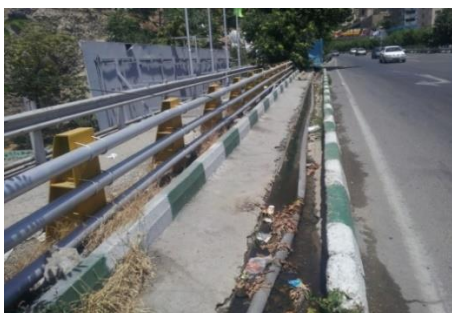
نشت آب باعث آسیب به پیاده‌رو شده است
