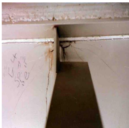
ترک در فلز پایه وجود دارد.
