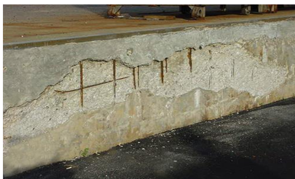
شکل ۱۸: ورقه‌ورقه شدن سطح بتن
