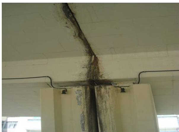
نشت در محل درز که باعث خرابی سازه شده است
