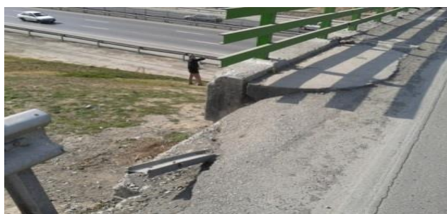
برخورد شدید باعث جابجایی و یا کنده شدن المان‌های نرده شده است. نرده‌های روی پل به گاردریل خارج از پل، اتصال ندارد
