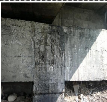
وجود ترک همراه با آثار رطوبت، اضمحلال بتن و آثار زنگ‌زدگی آرماتورها مشاهده می‌گردد
