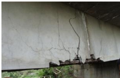
قلوه‌کن شدن و نمایان شدن آرماتورهای بتن و ایجاد ترک در تیر بتنی مشهود است
