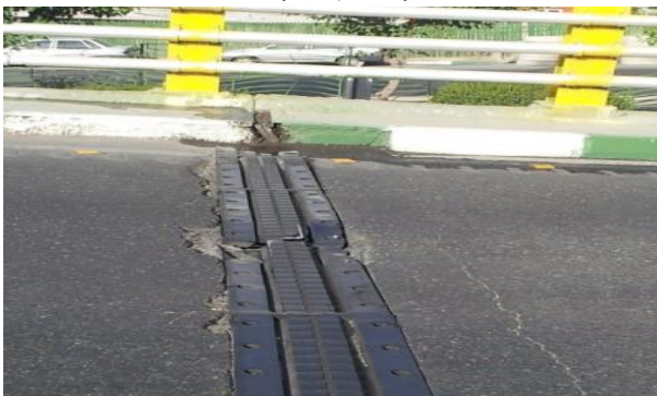
لق شدگی اجزاء درز و ایجاد صدا در یک مسیر هنگام عبور ترافیک. قلوه‌کن شدگی و ترک مشهود در مجاورت درز
