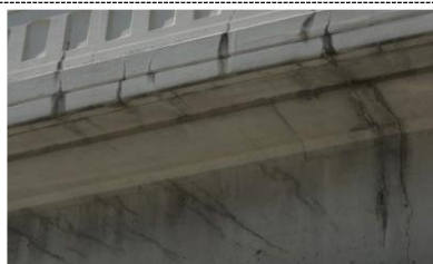
ترک‌های مشهود و گسترده در تیر و قرنیز عرشه قابل مشاهده است
