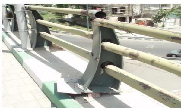
پست بطور کامل از پل جدا شده است المان‌های افقی نرده از پست جدا شده‌اند
