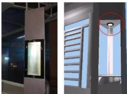
شکل ۶۶. محل نصب چراغ LED سیلندری در قسمت منشوری سمت چپ ایستگاه
