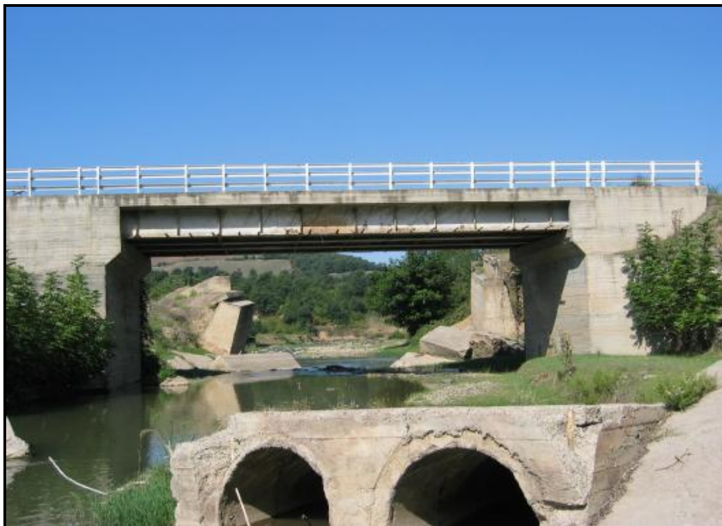
شکل 1-16- بقایای پل تخریب شده در محل پل روستای آرام نرو (نرماب) در حوضه گرگان رود [9]
