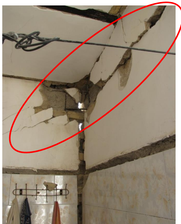
شکل (۶-۲۴): شکست اتصال برشی دیافراگم به تیر در ساختمان مصالح بنایی با کلاف
