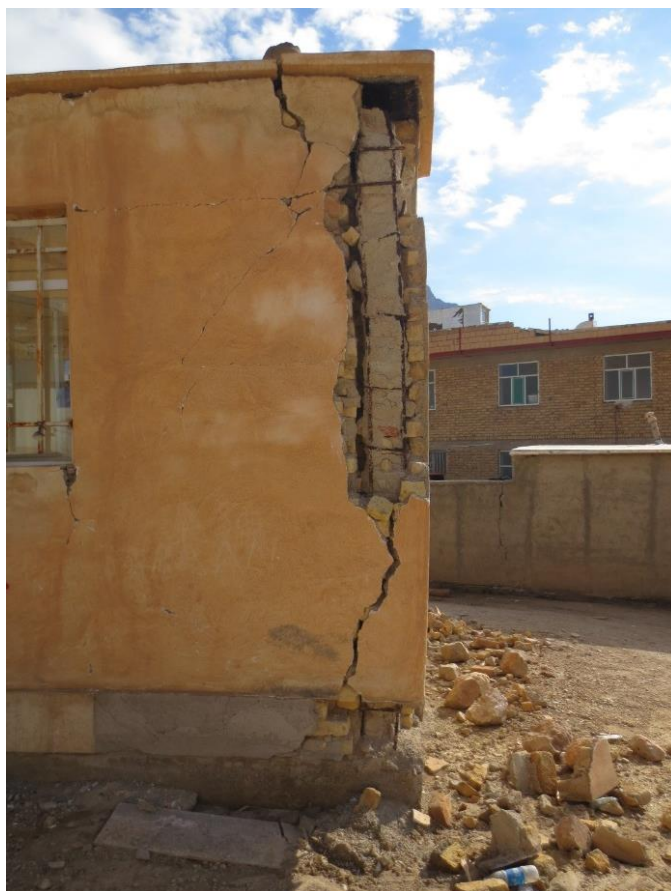
شکل (۶-۲۷): ترک خوردگی و شکستگی در دیوار یا پایه‌های یک ساختمان مصالح بنایی کلاف‌دار
