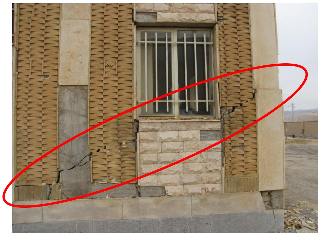
شکل (۶-۱۶): ترک خوردگی دیوار در یک ساختمان مصالح بنایی
