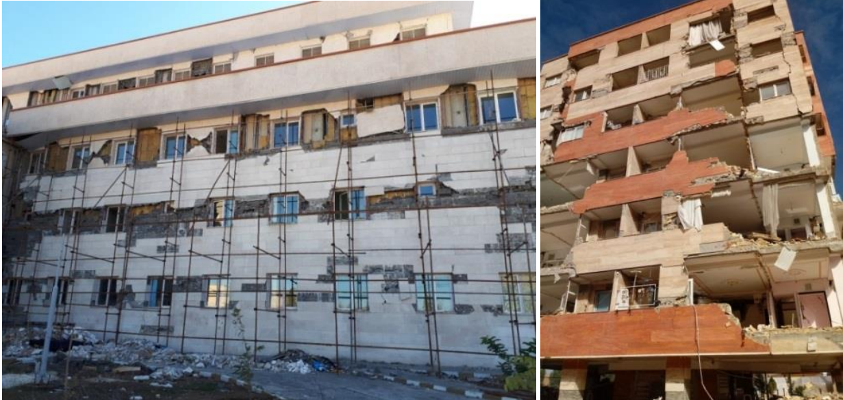
شکل (۸-۱): خطر فروریزش نمای ساختمان
