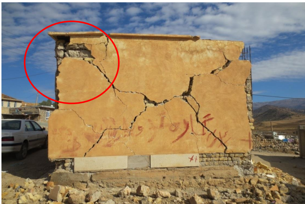
شکل (۶-۱۵): ورقه ورقه شدن یا جداسدگی لایه‌های دیوار در یک ساختمان مصالح بنایی بدون کلاف
