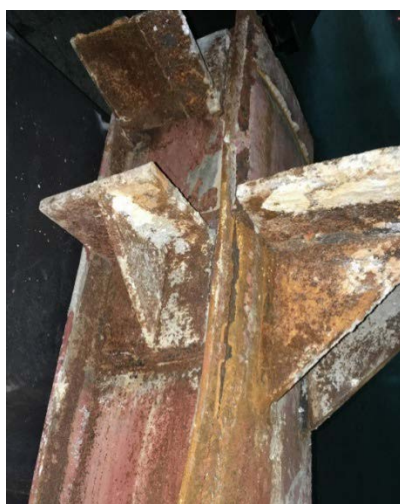
شکل (۴-۲۶): آسیب در جوش ورق تقویتی بال ستون
