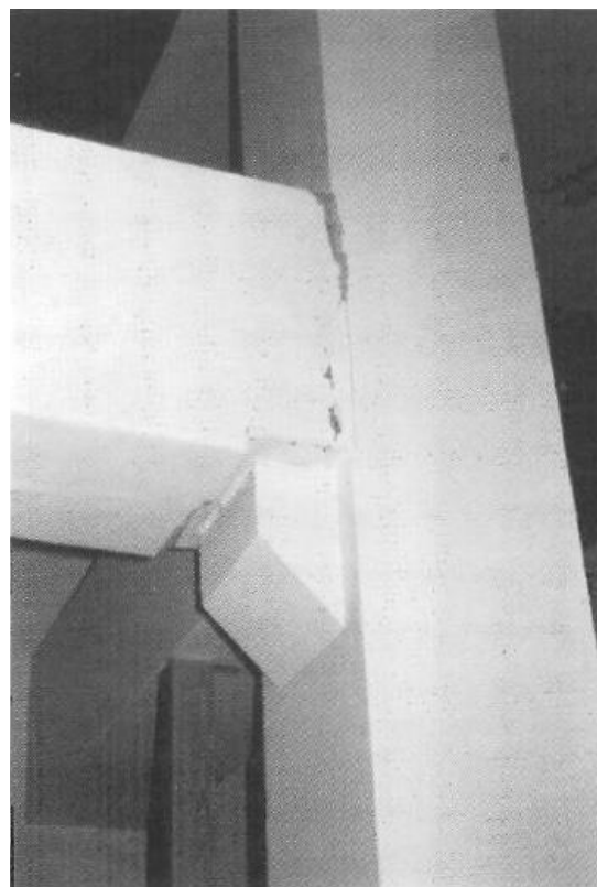
شکل (۵-۷): شکست در محل اتصال نشیمن تیر به ستون (براکت) در ساختمان بتن مسلح پیش‌ساخته
