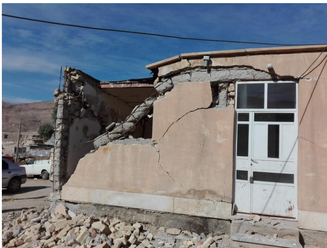
شکل (۶-۱۰): تابیدگی، شکستگی، صدمه دیدگی شدید در دیافراگم یک ساختمان مصالح بنایی
