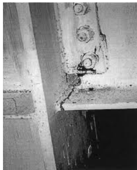
شکل (۴-۲۹): آسیب در اتصال پیچی
