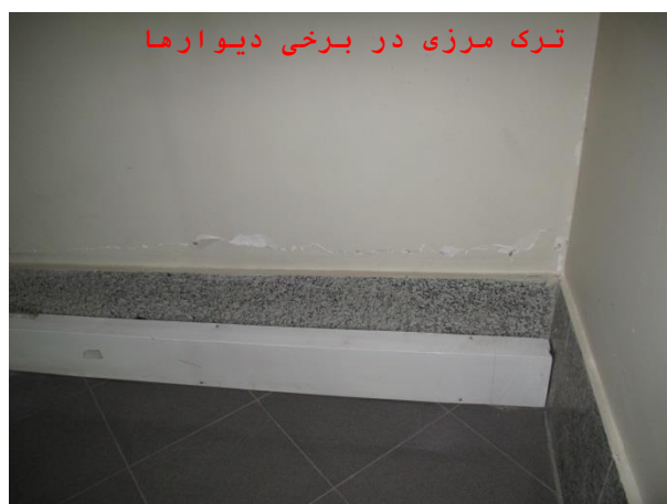
ترک با بازشدگی در کنج یکی از دیوارهای همکف
