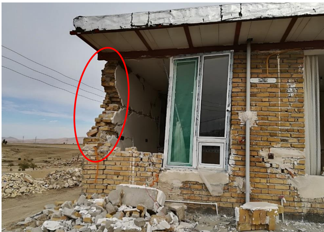
شکل (۳-۶): فروریزش موضعی در یک ساختمان مصالح بنایی بدون کلاف
