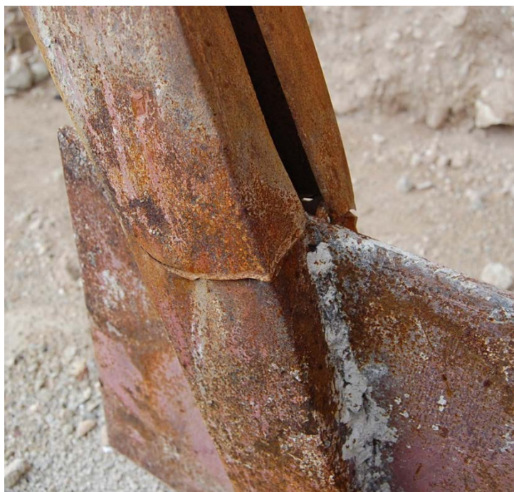
شکل (۴-۱۵): گسیختگی مهاربند (شکست کششی)
