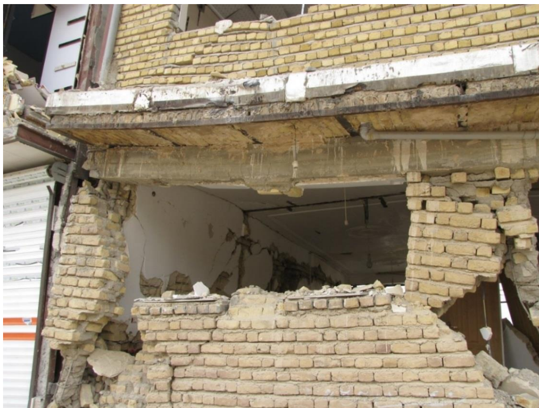
شکل (۶-۲۱): جابجایی مشهود ماندگار طبقات یک ساختمان مصالح بنایی کلاف‌دار
