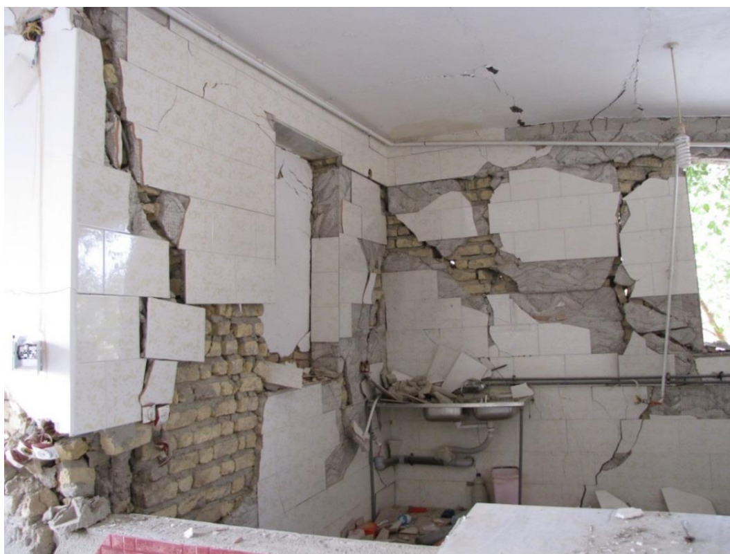
شکل (۶-۱۴): دیوارهای با ترک مورب پله‌ای شکل بزرگ در یک ساختمان مصالح بنایی بدون کلاف
