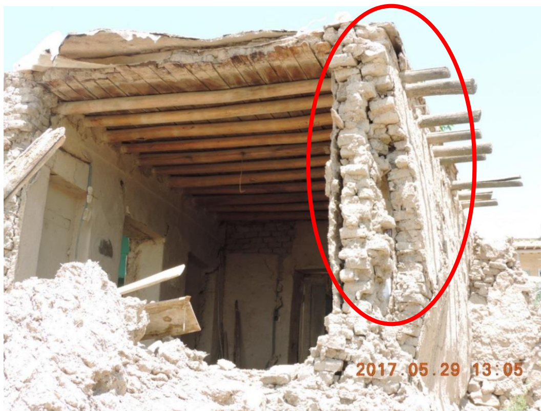
شکل (۶-۱۳): دیوار دارای نا شاقولی در یک ساختمان مصالح بنایی
