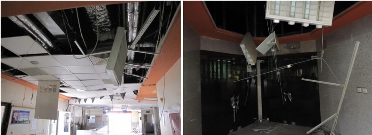
شکل (۸-۲): خطر سقوط سیستم سقف و وسایل روشنایی
