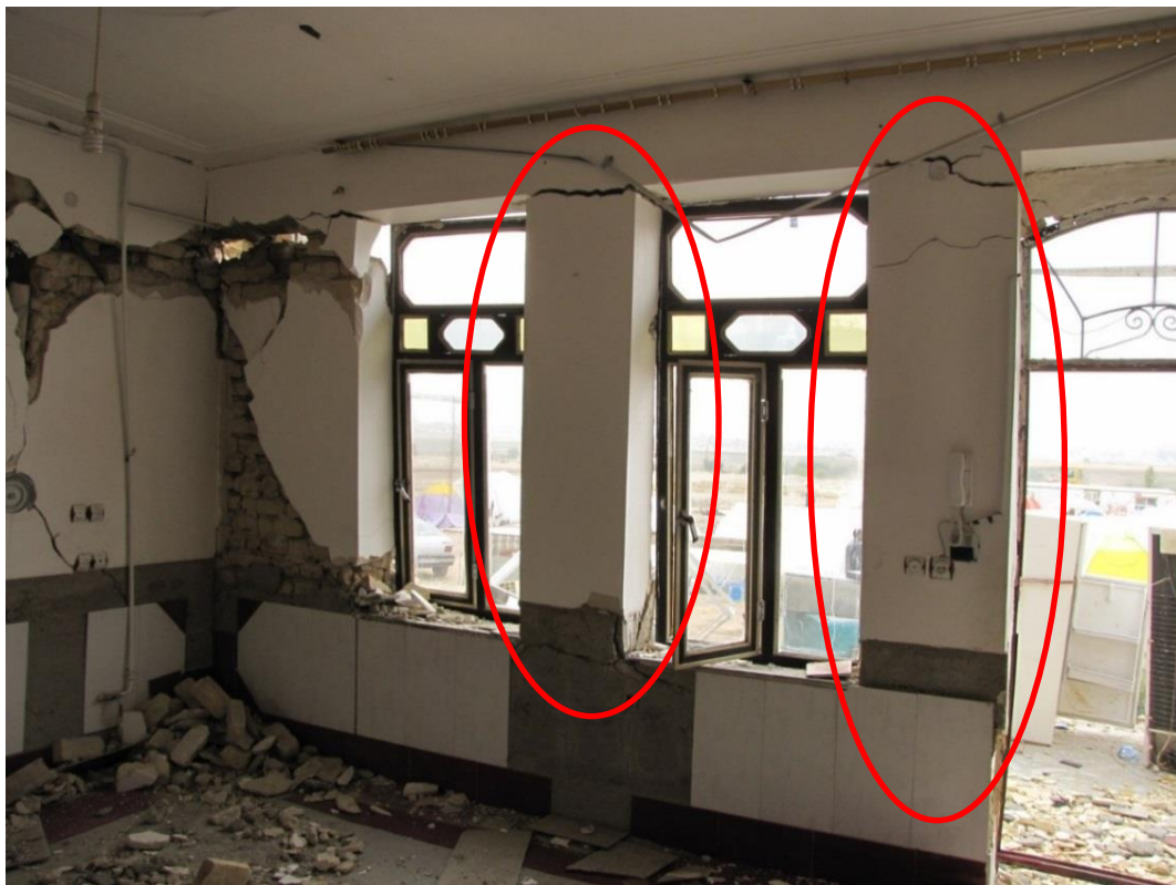
شکل (۶-۱۲): نا شاقول بودن اعضای باربر ثقلی در یک ساختمان مصالح بنایی بدون کلاف
