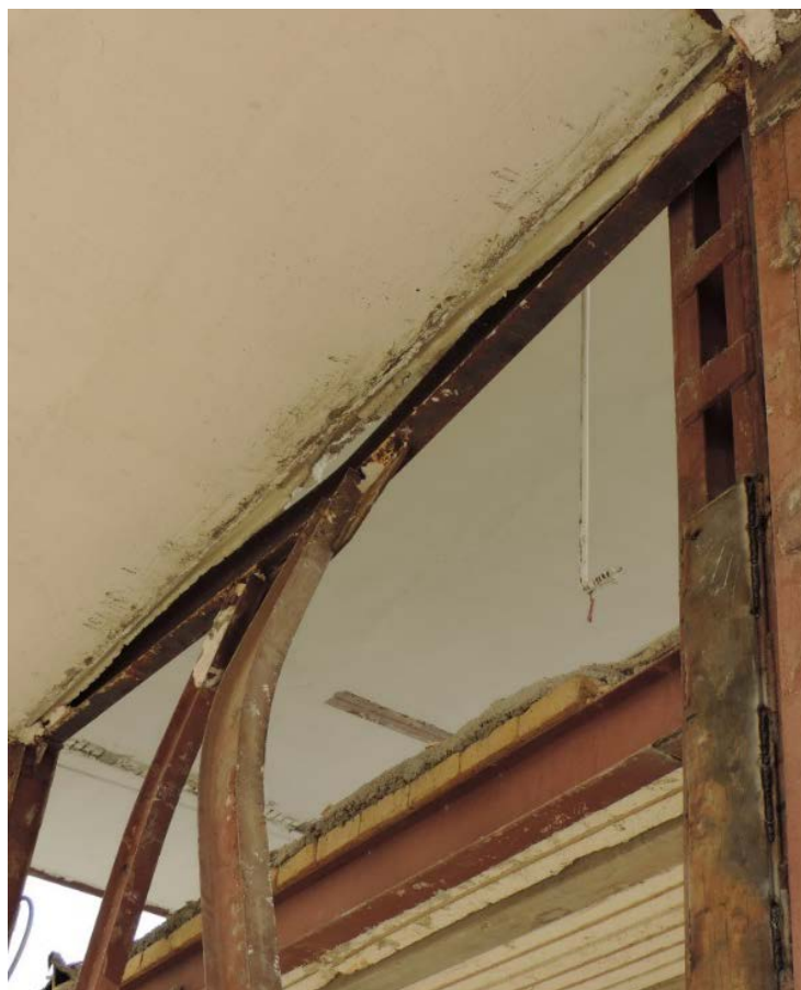
شکل (۴-۲۰): کمانش مهاربند در سیستم مهاربندی واگرا
