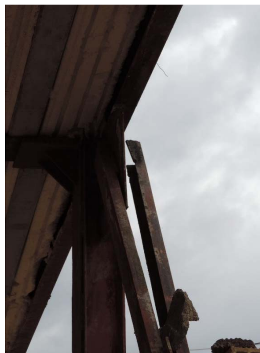
شکل (۴-۱۴): آسیب در جوش مهاربند
