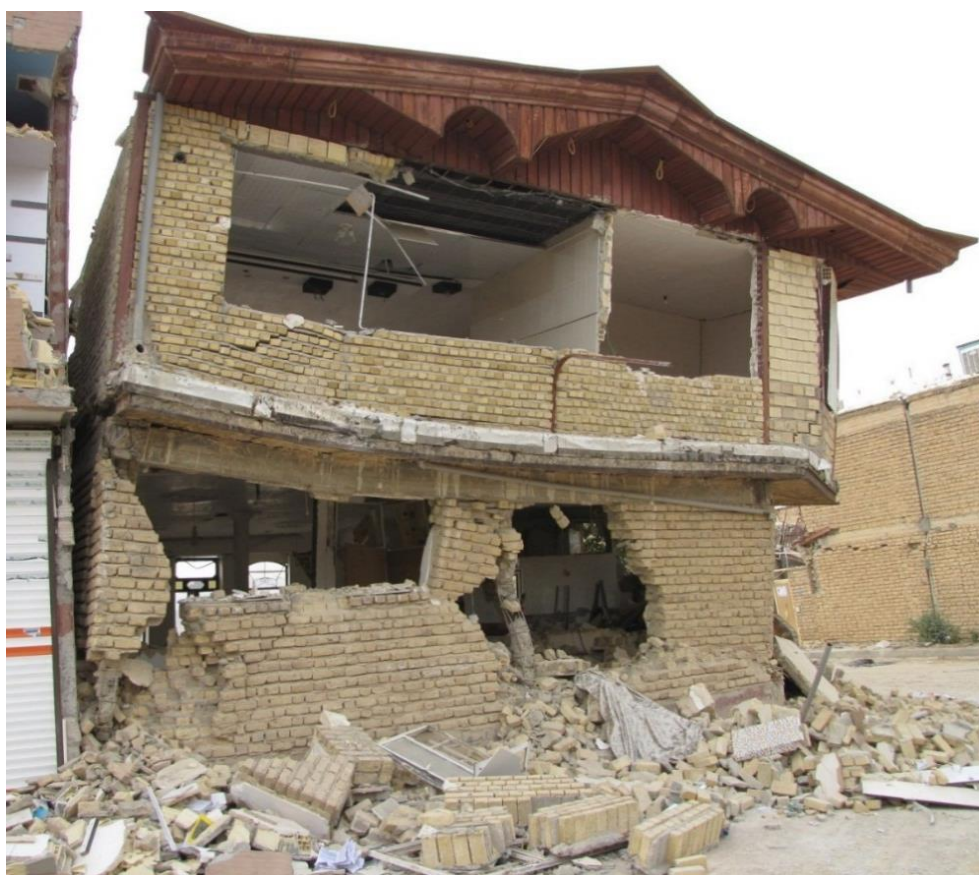
شکل (۴-۶): جابجایی مشهود ماندگار در طبقات یک ساختمان مصالح بنایی
