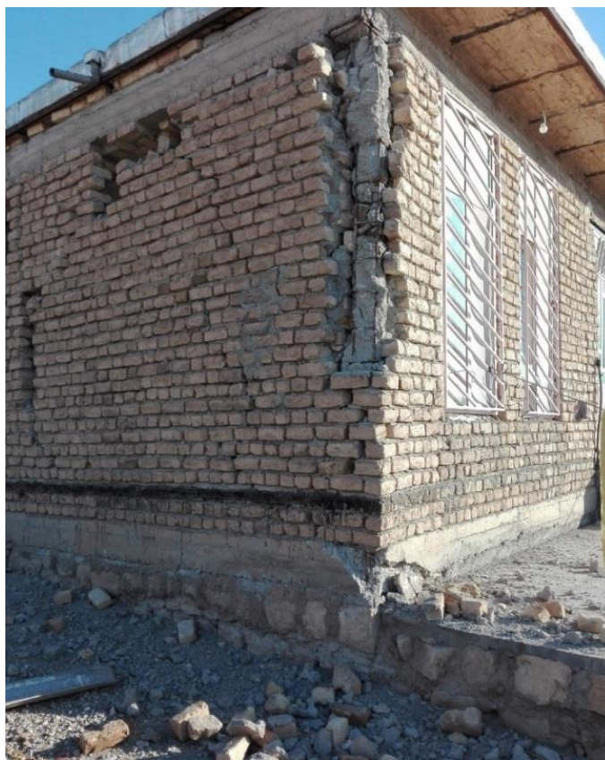
شکل (۶-۲۵): وجود ترک‌های عریض در دیوار یک ساختمان مصالح بنایی کلاف‌دار
