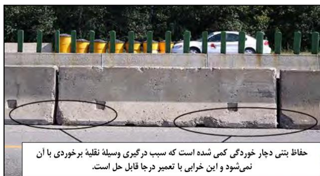
تصویر پ ۱: نمونه‌ای از خوردگی حفاظ بتنی که قابل تعمیر در محل است
