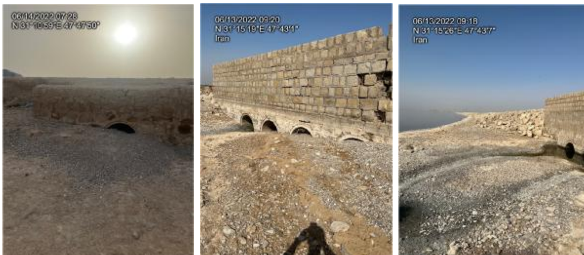
شکل ۲-۱۴: رسوب گرفتگی دهانه و داخل کالورت ها
