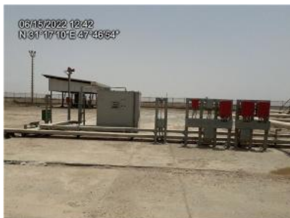
شکل ۲-۲۸: تابلو، و تجهیزات برقی
