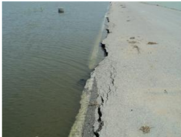
شکل ۱-۲: آبستگی کناره جاده ها و تخریب لایه های روسازی
