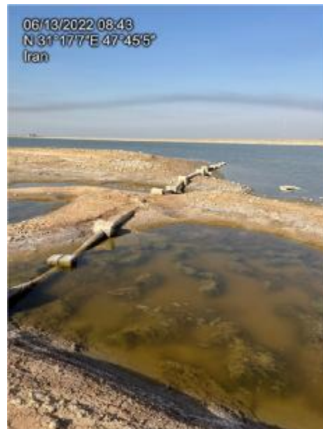
شکل ۲-۱۹: خطوط لوله انعطاف پذیر عبوری از کف تالاب با قطر ۶ اینچ از شرکت Soluforce هلند تصویر سمت راست خط لوله انعطاف پذیر کشیده شده از کف تالاب و سمت چپ مشخصات خط لوله استفاده شده
