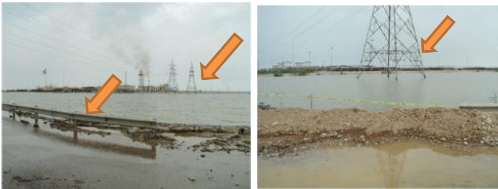
شکل ۲-۳: آبگرفتگی پایه تیرهای برق، دکل ها و گاردریل ها، (فلش ها نشان دهنده محل آسیب است)
