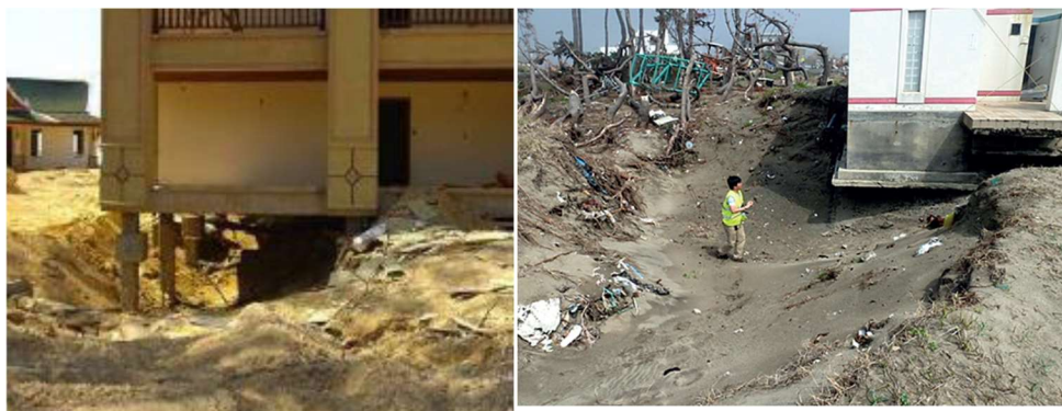
شکل ت-۱۵-۱۲ تصاویری از آب‌شستگی موضعی
