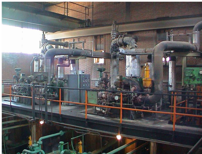
شکل ت-۸-۱ نمونه‌ای از اجزای غیرسازه‌ای در تأسیسات صنعت نفت- کمپرسور هوا
