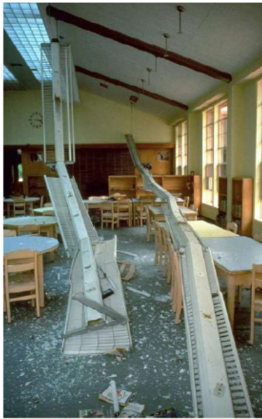
شکل ت-۸-۳۲ آسیب در تجهیزات برقی در زلزله بوژ هندوستان در سال ۲۰۰۱
