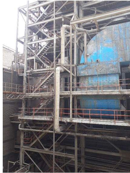
شکل ت-۸-۸ الف: امتداد لوله در ارتفاع و پلان سازه که به دلیل وجود حرمت نسبی احتمالی در زمان زلزله باید در طراحی مدنظر قرار گیرند (پالایشگاه تهران). ب) آسیب در لوله‌کشی در زلزله بوژ هندوستان
