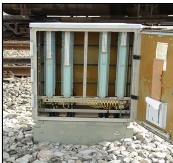
شکل ۵-۶- نمایش از جعبه DC نصب شده
