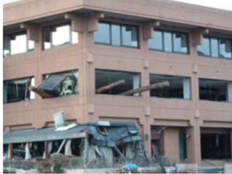
شکل ت-۱۵-۹ برخورد تیرهای چوبی آوار در سونامی به ساختمان
