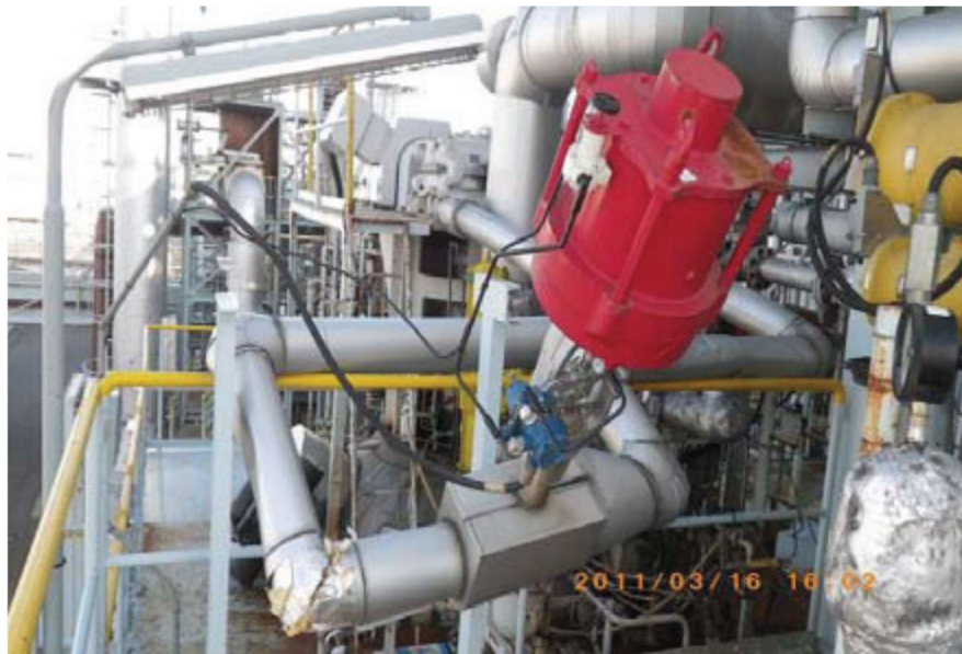
شکل ت-۸-۲ آسیب‌های لرزه‌ای به اجزای غیرسازه‌ای یک سایت پتروشیمی، آوریل ۲۰۱۱ استان فوکوشیما، کشور ژاپن، الف) آسیب اتصال لوله در بخش فوقانی یک مخزن، ب) جداشدگی لوله و شیرهای کنترل
