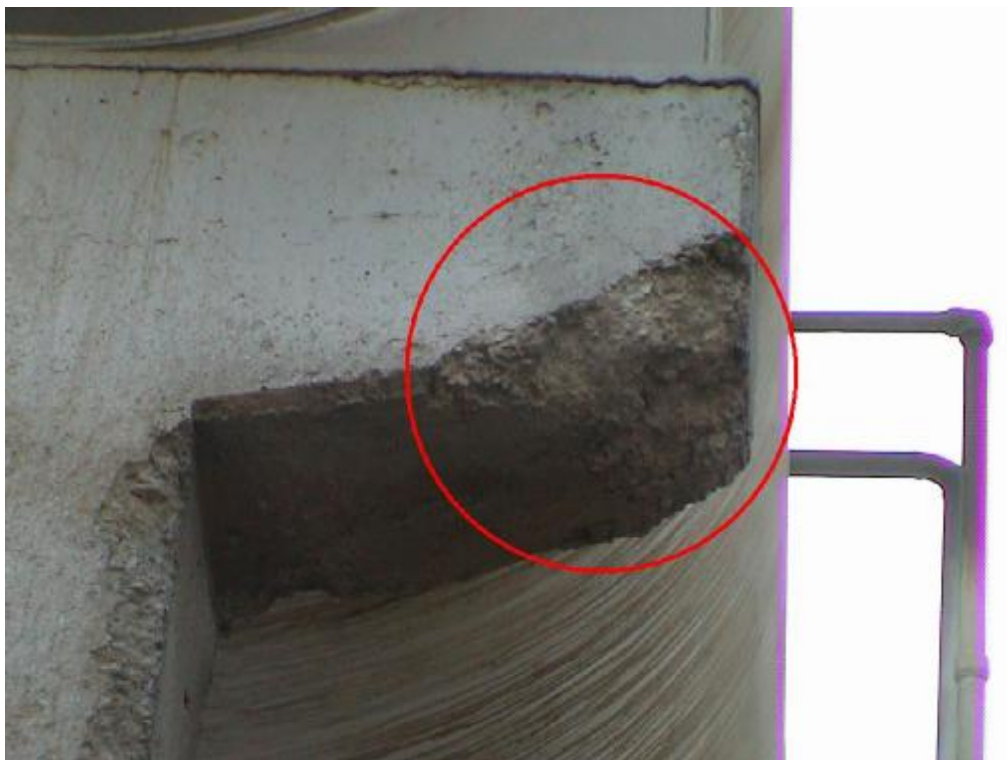
شکل ۱۹- زوال در بتن نگهدارنده تجهیزات
