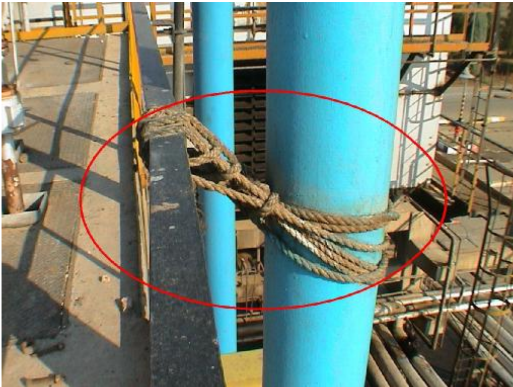
شکل ۳۱- نگهداری نامناسب لوله
