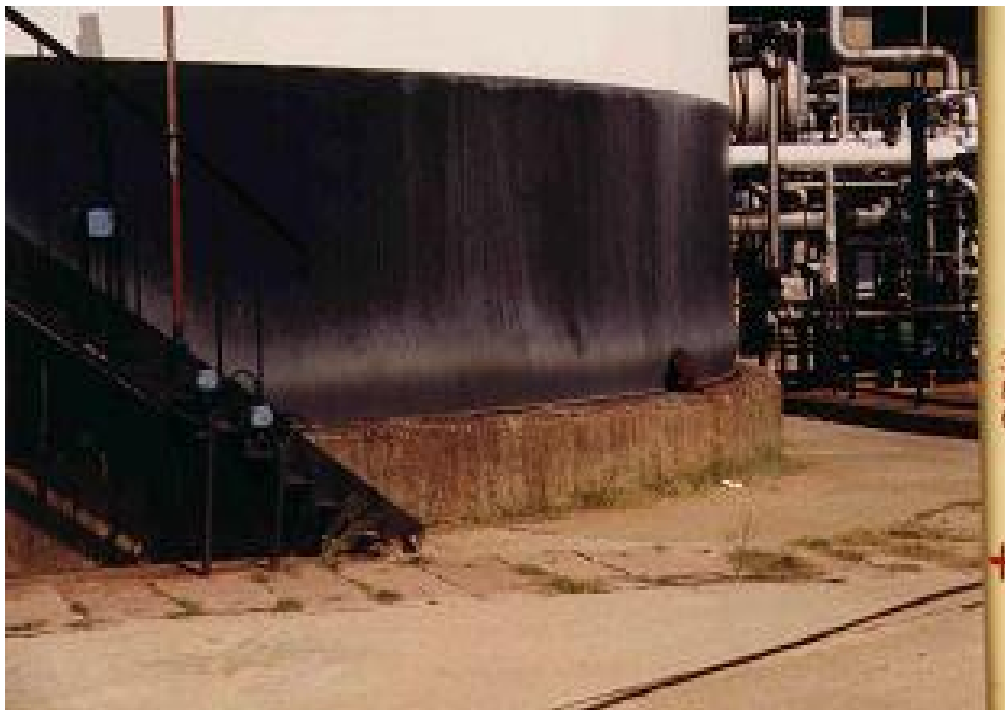
شکل ۴- کمانش پافیلی در مخزن ( زلزله ازمیت )
