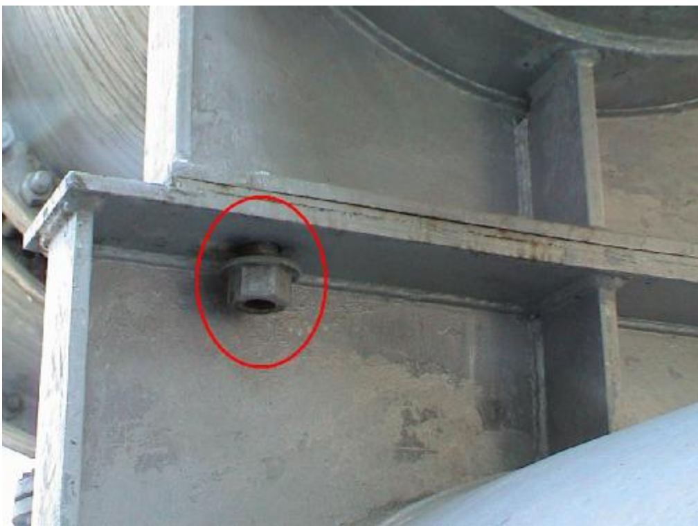
شکل ۱۶- شل بودن پیچ و مهره اتصال
