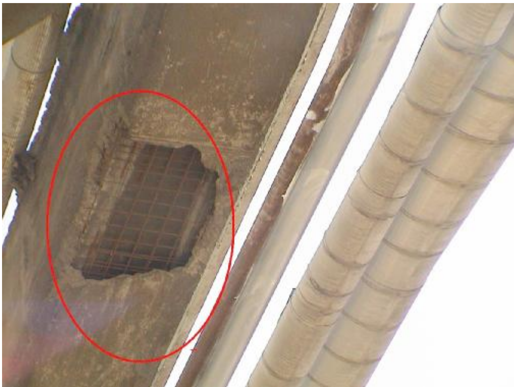
شکل ۲۸- زوال در پوشش بتنی سازه های فولادی
