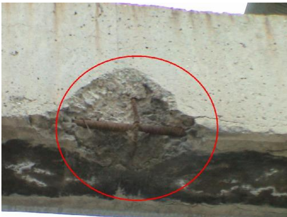
شکل ۲۰- بیرون زدگی میلگرد سازه بتنی
