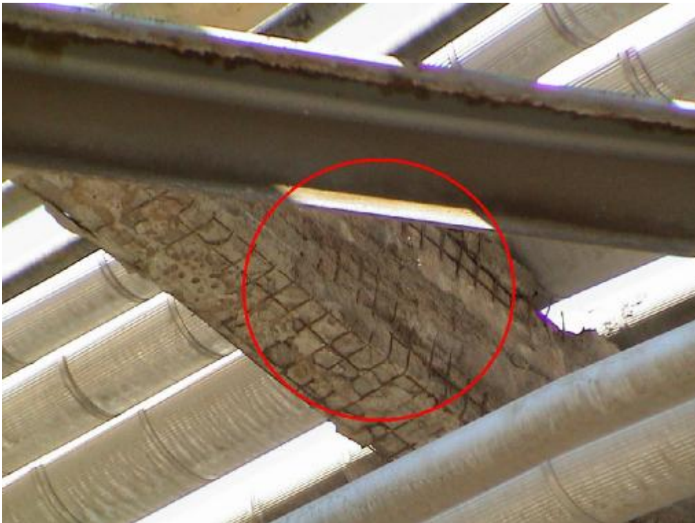
شکل ۲۹- زوال در پوشش بتنی سازه های فولادی
