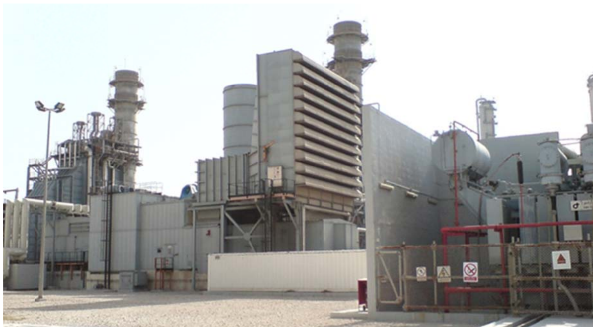
شکل ۴-۲۷- محل قرار گیری توربین گاز و فیلترهای ورود هوا در پروژه شماره ۱۰
