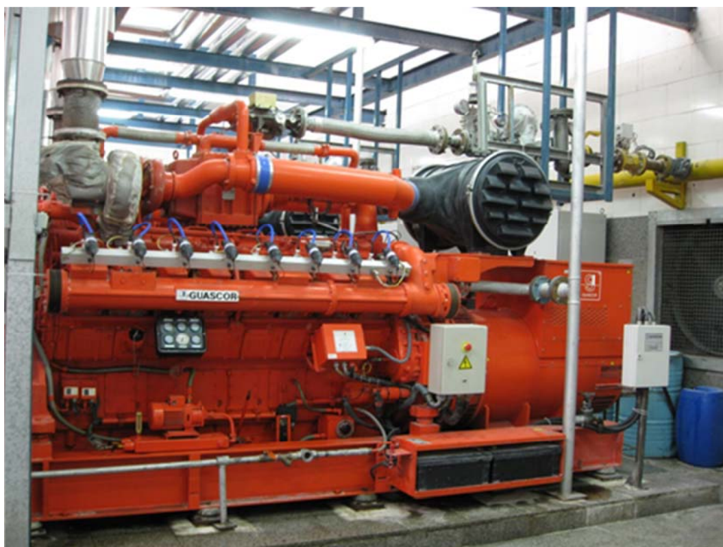
شکل ۴-۱۴- موتور GUASCOR مدل SFGLD 560 در پروژه شماره ۶
