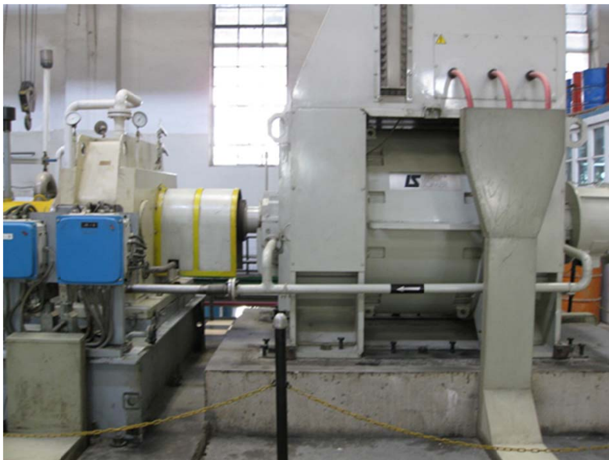
شکل ۴-۳- ژنراتور دستگاه CHP پروژه شماره ۱
