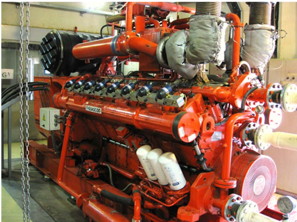
شکل ۴-۲۴- موتور GUASCOR مدل SFGM 560 در CHP پروژه شماره ۹
