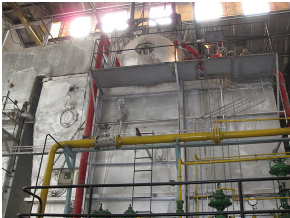
شکل ۲-۴- بویلر مربوط به پروژه شماره ۱
