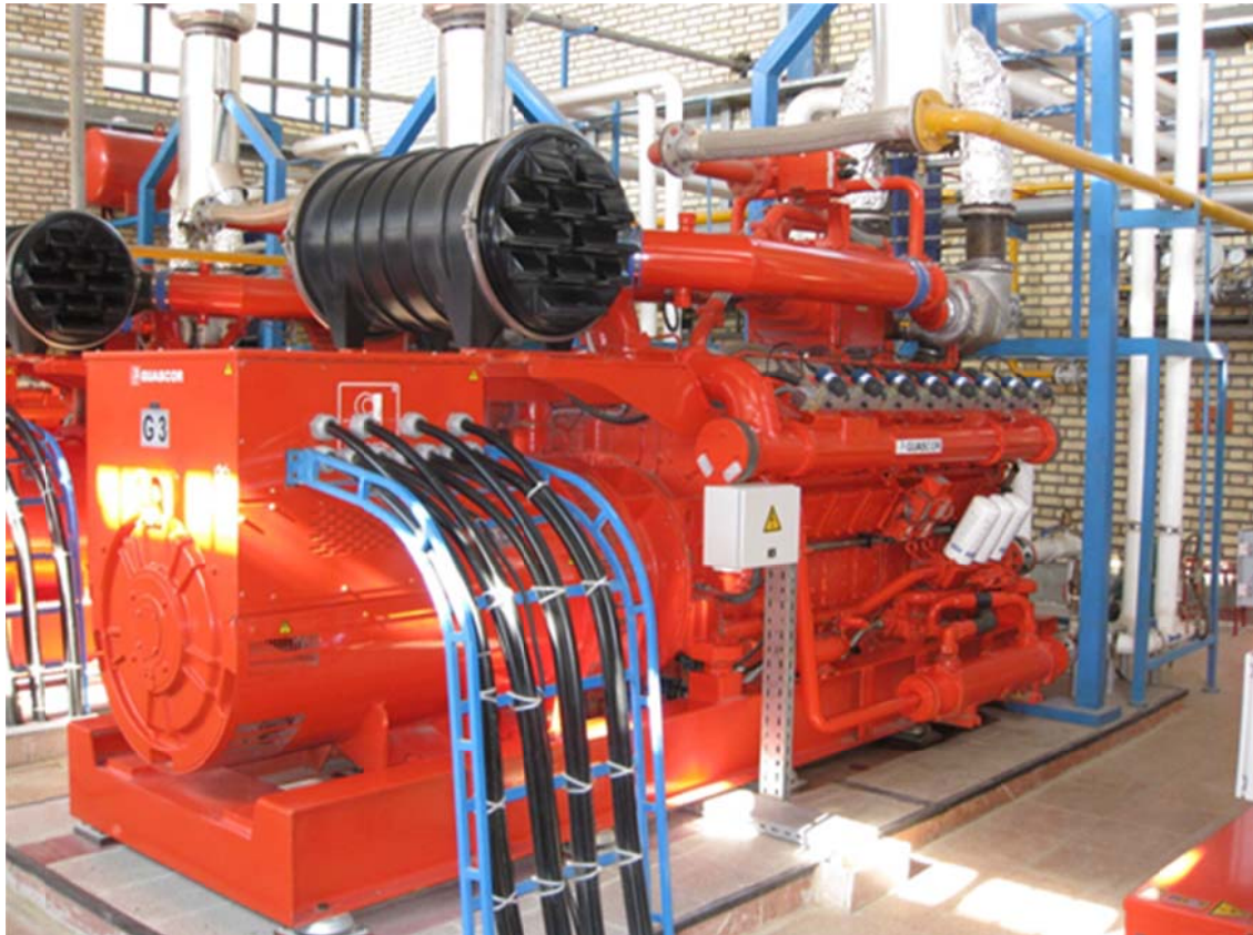
شکل ۴-۱۰- موتور GUASCOR مدل SFGM 560 در پروژه شماره ۴
