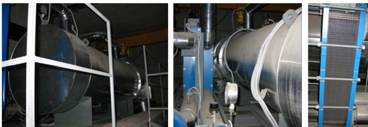
شکل ۷-۴- مبدل‌های پروژه CHP پروژه شماره ۲
