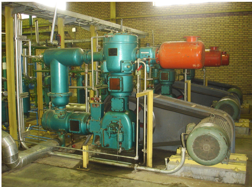
شکل (۵-۲۰): کمپرسورهای هوا
