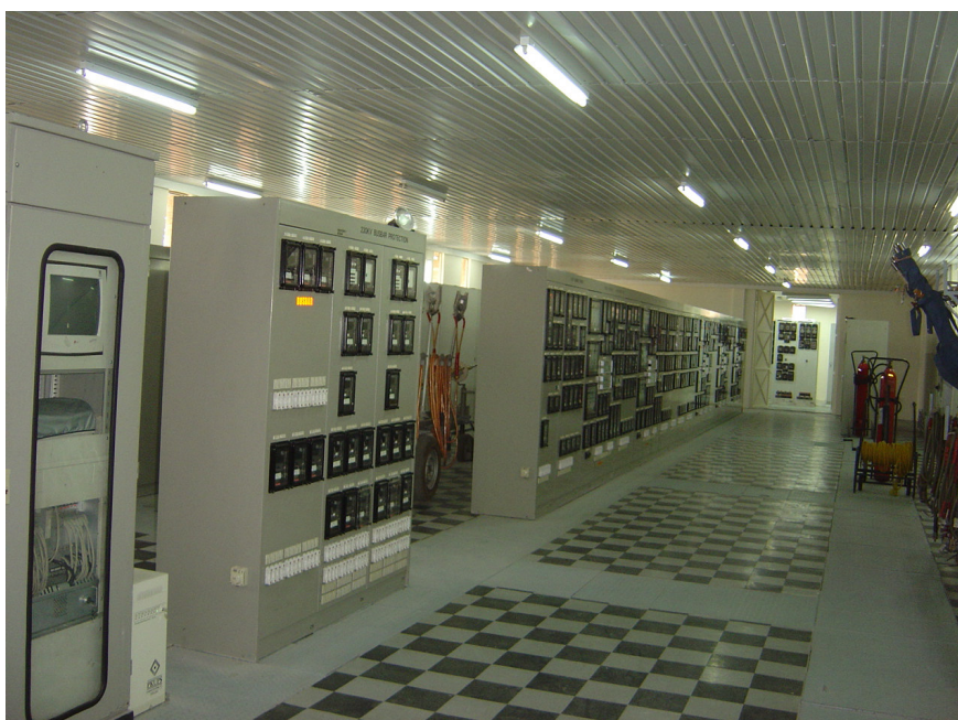
شکل (پ-۵-۸): پانل کنترل و تجهیزات ابزار دقیق
