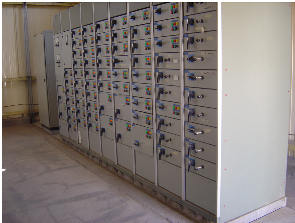
شکل (پ-۵-۲): تابلوهای مرکز کنترل موتور
