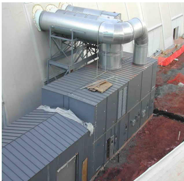
شکل (پ-۵-۲۳): هواسازها
