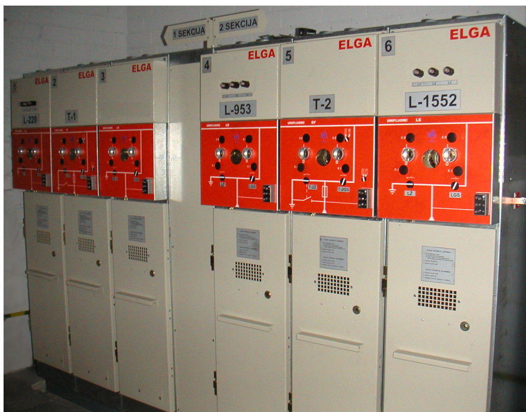
شکل (پ-۵-۴): تابلوهای کلیدزنی فشار متوسط
