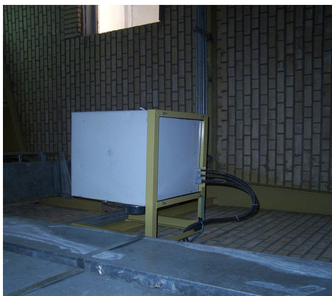
شکل (پ-۵-۶): ترانسفورمرها
