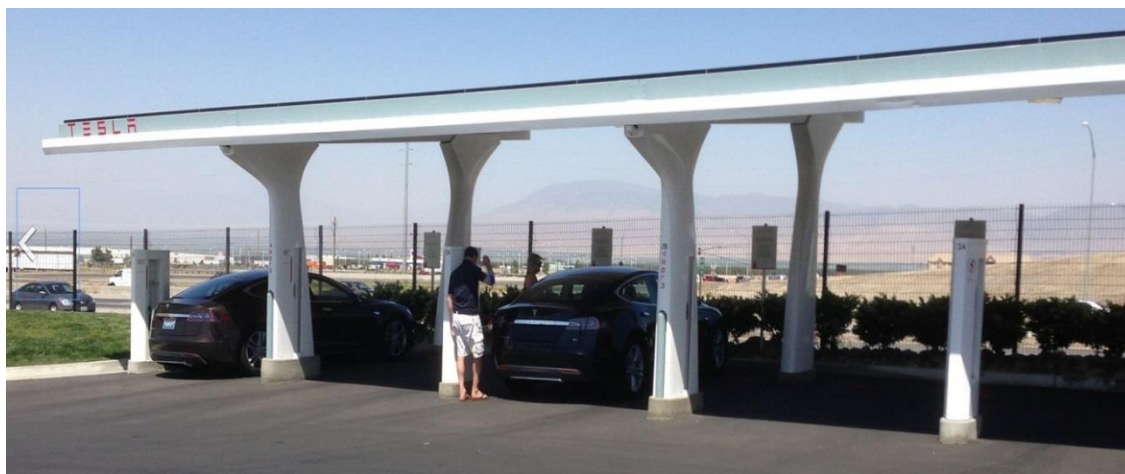
شکل ۲-۵: ایستگاه شارژ عمومی خودرو برقی با بهره‌گیری تکنولوژی اتصال سوپر شارژرهای تسلا، کالیفرنیا
