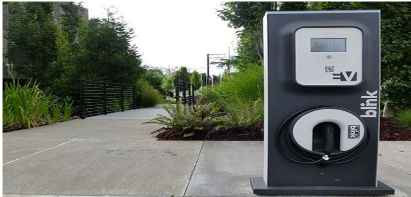
شکل ۴-۱۹: یک نمونه از شارژر سطح دوم از شبکه ایستگاه‌های عمومی Blink Network
