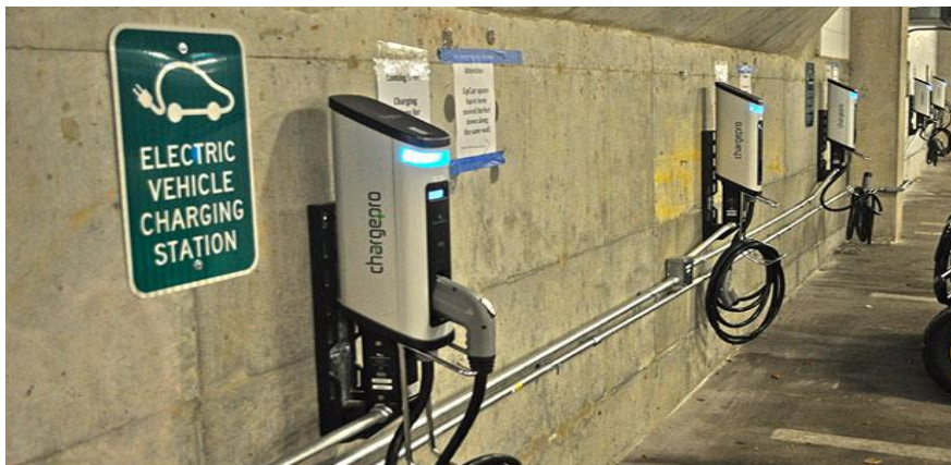
شکل ۴-۲۵: یک نمونه از شارژر سطح دوم از شبکه ایستگاه‌های عمومی SemaConnect
