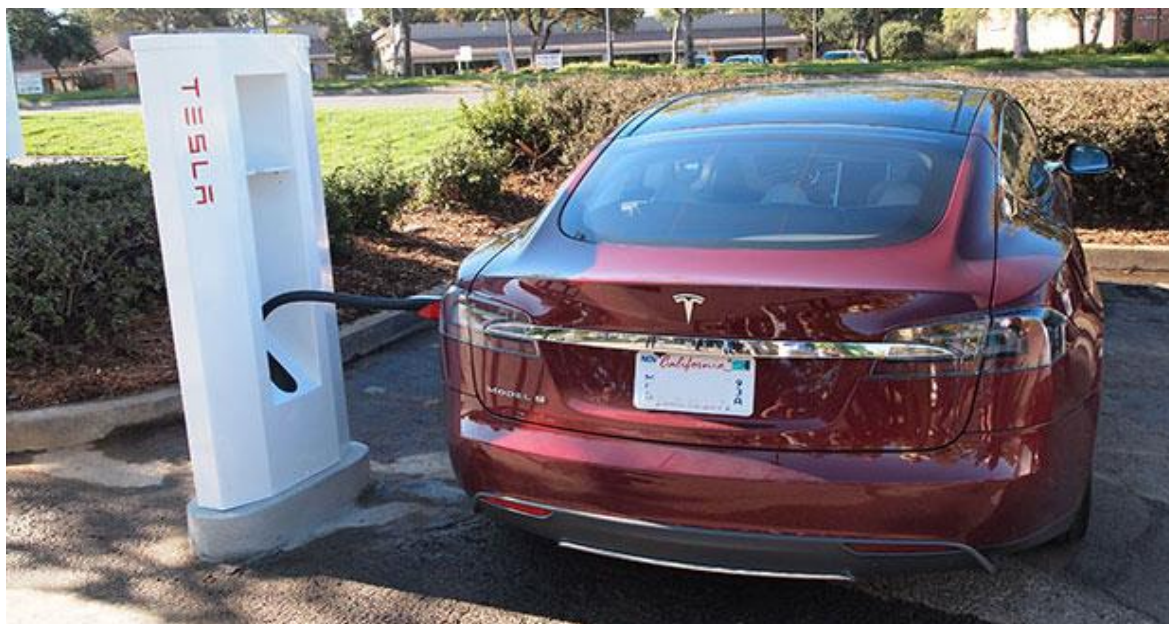
شکل ۴-۲۷: یک نمونه از سوپرشارژر سطح سه از شبکه ایستگاه‌های عمومی Tesla SuperChargers
