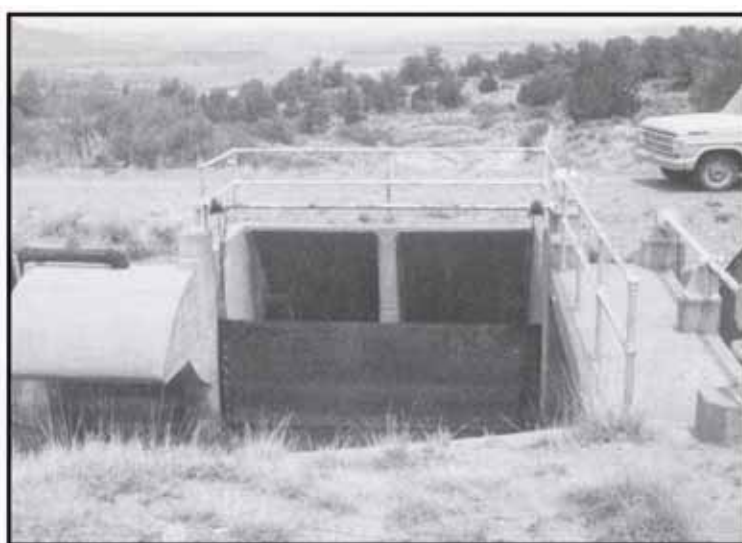
شکل ۷- کلاهی سرریز سیفونی در چپ، دریچه قطاعی هرز آبرو در مرکز و بالابرنده دریچه قطاعی سازه تنظیم سطح آب در طرف راست تصویر
