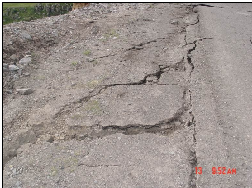
شکل ۱-۱۷ - ترک خوردگی زمین
