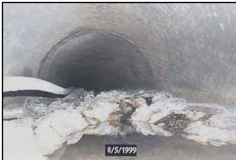
شکل ۶-۱۷-د- مانع در مسیر از نوع لوله یا کابل خارجی در ساعت ۹
