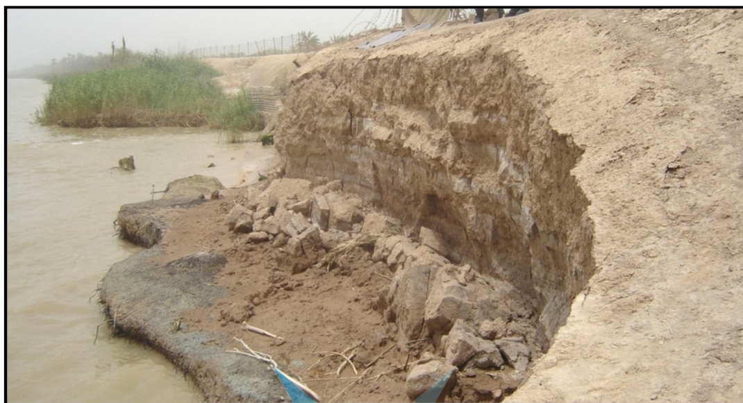
شکل ۲-۲- نمونه‌ای از رخداد پدیده ریزش کناره رودخانه
