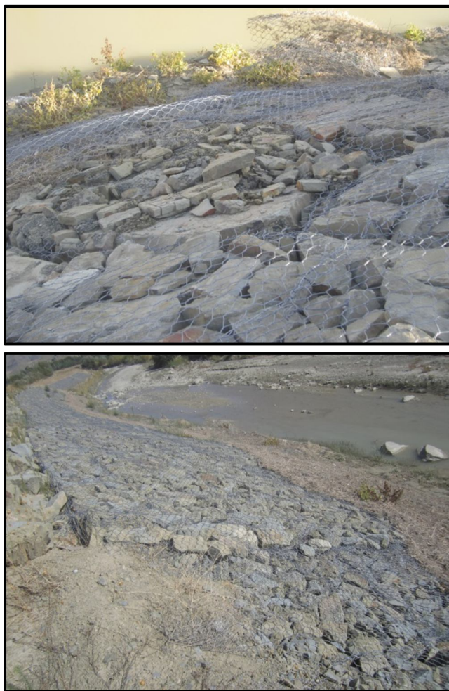
شکل ۴-۱- نمونه‌هایی از رخدادهای خرابی در توریسنگ‌ها
