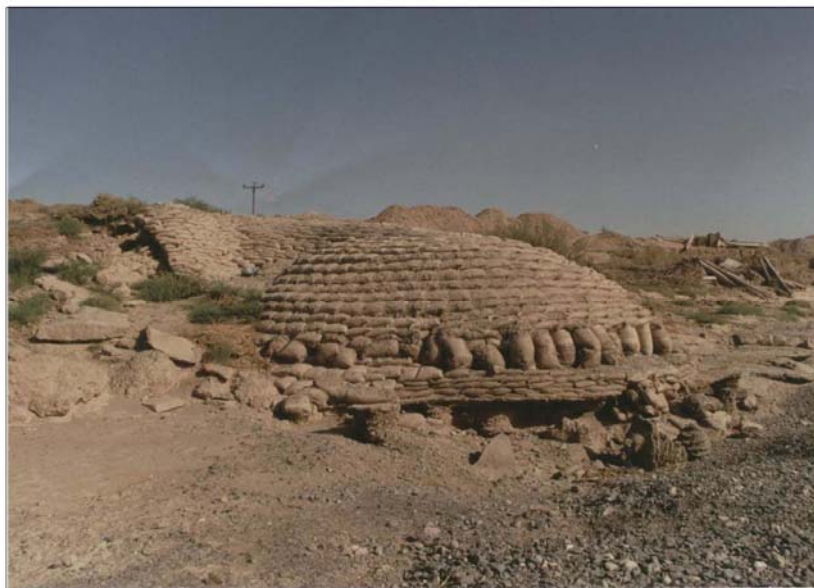
شکل ۸-۵- توسعه آبستگي موضعی و تخریب پنجه آبشکن کیسه‌ای، رودخانه سرخس [۴۵]
