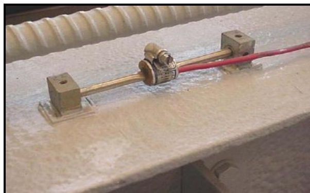
شکل 1-11- نمونه‌ای از یک کرنش‌سنج سطحی نصب شده
