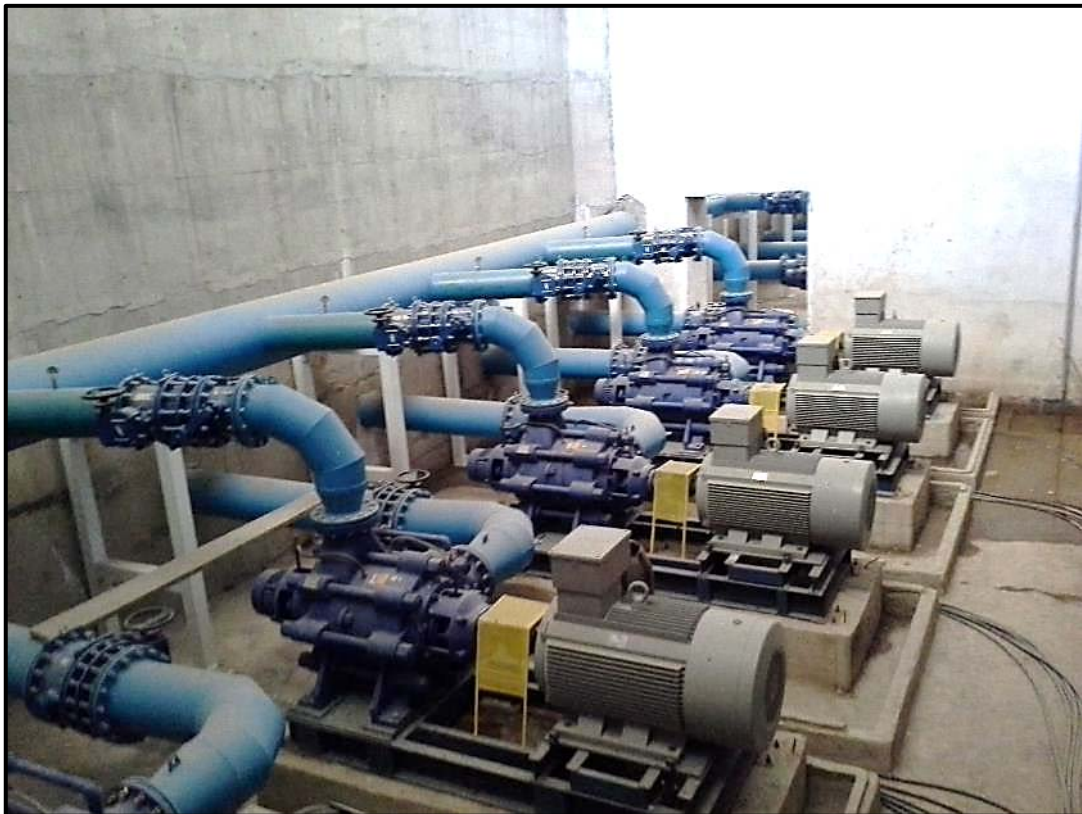
شکل ۳-۳۵- چند پمپ موازی در کنار هم، ایستگاه پمپاژ رودخانه سیمره
