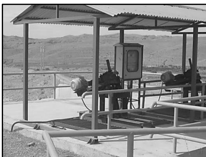
شکل ۳-۲۲- عمل‌گر برقی دریچه قطاعی در شبکه آبیاری زنوز آذربایجان شرقی
