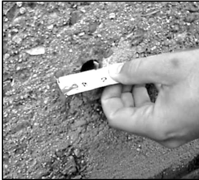
شکل ۳-۲۸- قطر نامناسب لوله ورودی اتصال به چاهک آرامش برای خودکارسازی
