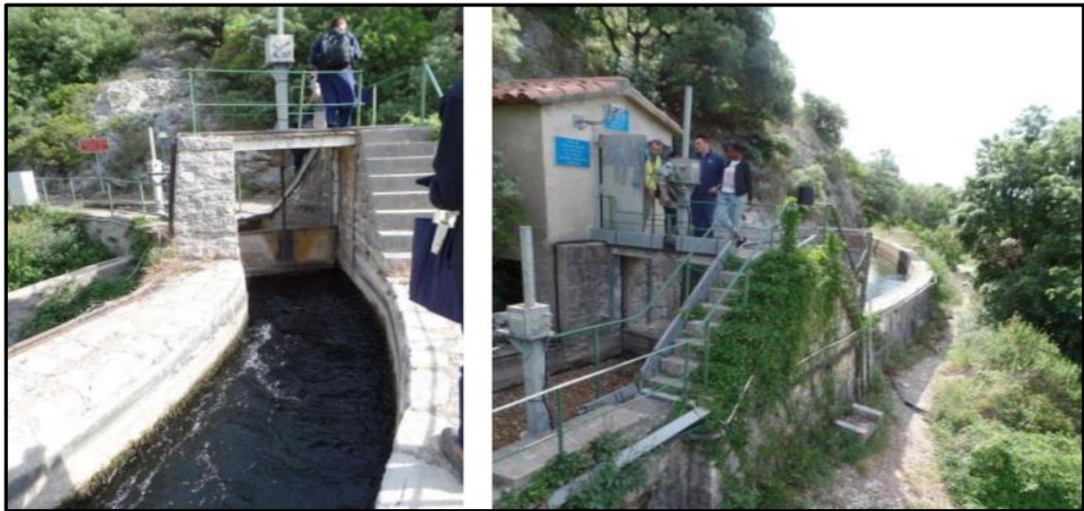
شکل ۳-۶- دریچه‌های کشویی خودکار و یک ایستگاه پایش در کانال گیگناک فرانسه
