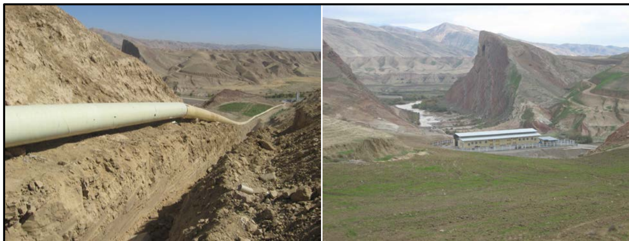
شکل پ.۱-۱۰- ایستگاه پمپاژ و خط لوله انتقال به ارتفاع حداقل ۱۵۰ متر از رودخانه سیمره
