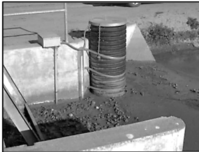
شکل ۳-۲۹- چاهک اندازه‌گیری در کنار یک سازه خودکار در موقعیتی با سرعت جریان کم در یک کانال آبیاری نشده؛ مناسب قرائت سامانه خودکار
