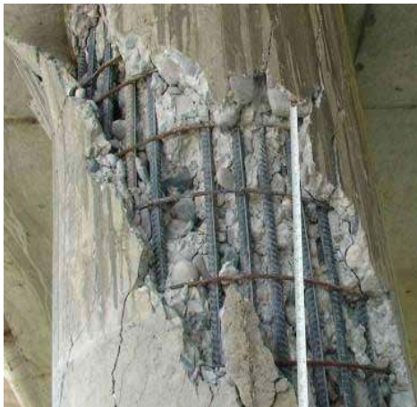
قسمت فوقانی ستون ترک برشی خورده است.
