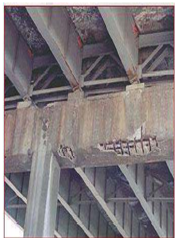
بتن سر ستون ورقه ورقه شده است. دال بتنی شوره زده است. خوردگی تیرهای فلزی در محل درز آغاز شده است.
