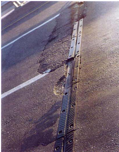
آسفالت اطراف درز قلوه کن شده است. درز در قسمتی از طول با آسفالت پر شده است. لاستیک درز در طول کمی، از بین رفته است.
