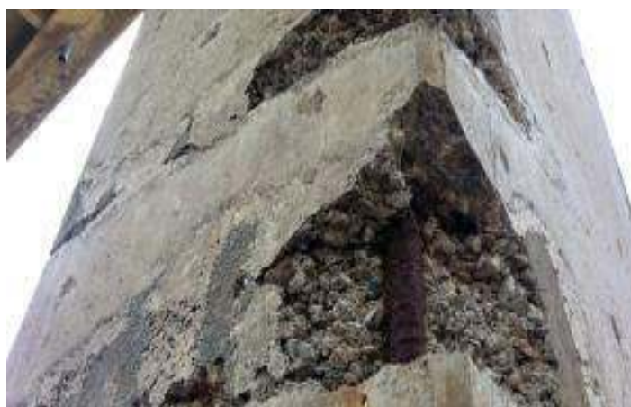
شکل ۳: قلوه‌کن شدن بتن
