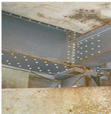
زنگ زدگی تیرها و تکیه گاه ها شروع شده است.
