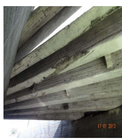
قلوه کن شدن چند تیر و وجود ترکهای ریز نشانه اولویت متوسط تعمیر است.
