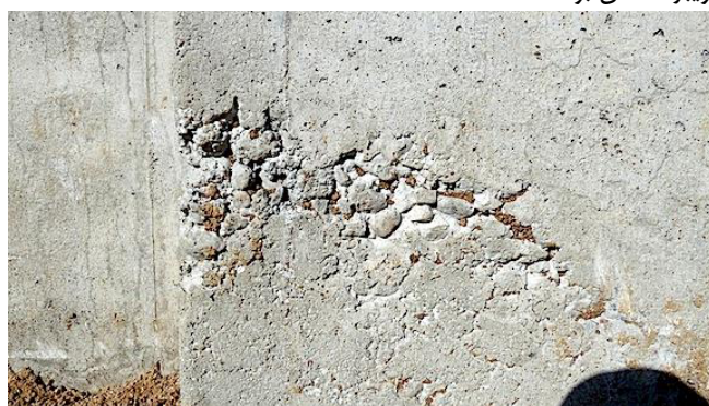
شکل ۵: کرمو شدگی بتن
