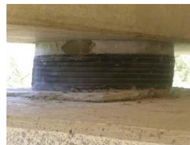
تورم ناچیز در تکیه‌گاه الاستومریک دیده می‌شود. بتن فوقانی تکیه‌گاه کمی آسیب دیده است.
