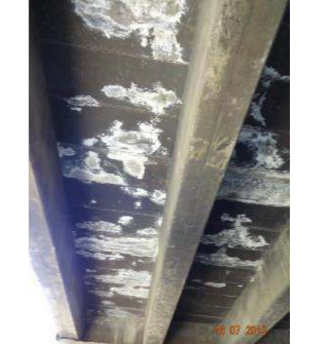
شوره زدگی شدید در دال بتنی وجود دارد که نشانه فقدان یا آسیب دیدگی ایزولاسیون عرشه است.
