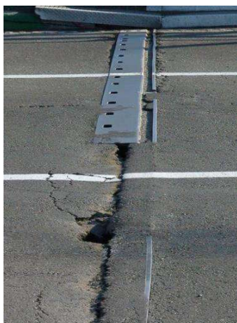
قسمت اعظم ورق فلزی درز کنده شده و با آسفالت پر شده است.
