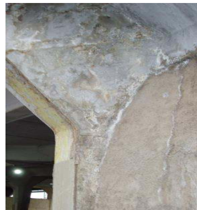
ترک‌خوردگی و اضمحلال بتن در پایه پل نشانگر اولویت متوسط تعمیر است.
