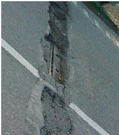
به دلیل انجام آسفالت مکرر، سطح آسفالت به میزان قابل توجهی بالاتر از سطح درز قرار گرفته است. چاله ایجاد شده باعث اختلال در ترافیک شده است. قسمت اعظم طول درز با آسفالت پر شده است.
