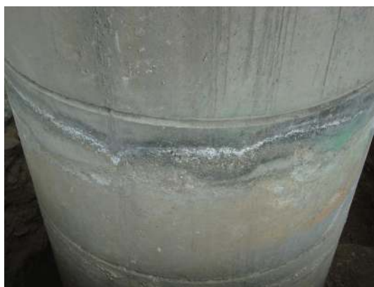
مقداری اضمحلال، شوره‌زدگی در انتهای پایه مشاهده می‌شود. البته ممکن است آسیب ایجاد شده ناشی از عوامل محیطی بیش از مقداری باشد که دیده می‌شود.
