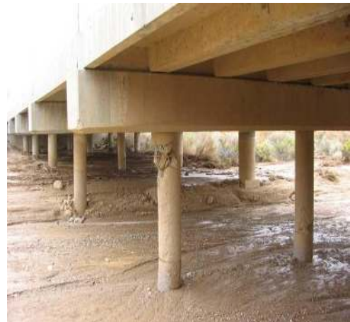
یکی از ستون‌ها دچار شکست خمشی شده است.
