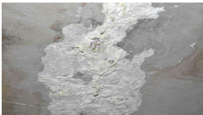
شکل ۴: شوره زدن بتن
