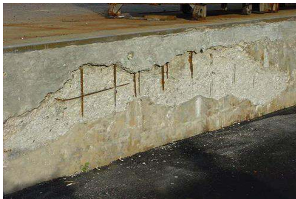
شکل ۲: ورقه ورقه شدن سطح بتن
