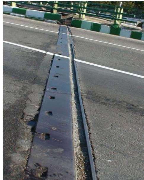
درز با خاک و خاشاک پر شده است و بتن اطراف درز ترک خورده و کمی قلوه کن شده است.
