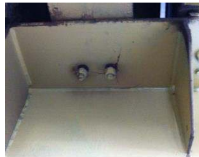
فلز پایه در سرستون ترک خورده است.
