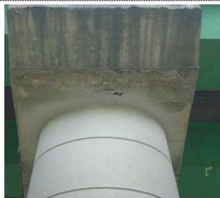
لکه‌های آب، نشانگر آغاز ایجاد لکه‌های زنگ است. اضمحلال بتن سرستون آغاز شده است.
