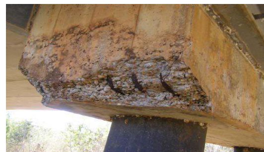
نمایان شدن آرماتورها، هوازگی قابل توجه قسمت انتهایی و قله‌کن شدن متوسط، نشانه آسیب با اهمیت متوسط است.
