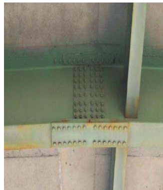
خوردگی و زنگ زدگی اعضای فلزی پل شروع شده است.
