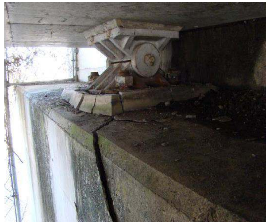
ملاط زیر سکو و بتن نشیمنگاه و زیرسازه ترک خورده است.
