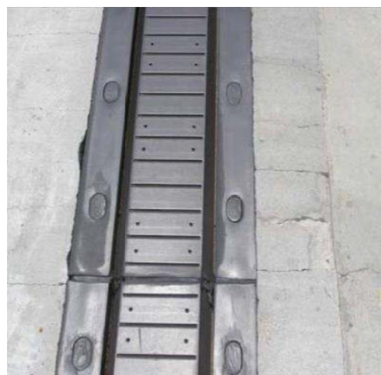
بتن اطراف درز ترک خورده است
