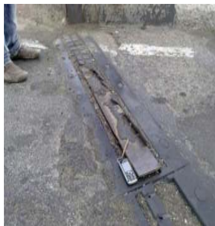
درز با خاک و خاشاک پر شده است. قسمتی از ورق فلزی درز کنده و بلند شده است. لاستیک روی درز در طول قابل توجهی از بین رفته است.
