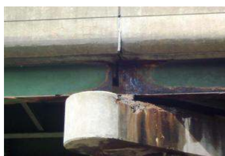
تیرهای فلزی در محل درز به شدت دچار خوردگی و زنگ‌زدگی شده‌اند. سر ستون بتنی هم قله‌کن شده و آسیب دیده است.
