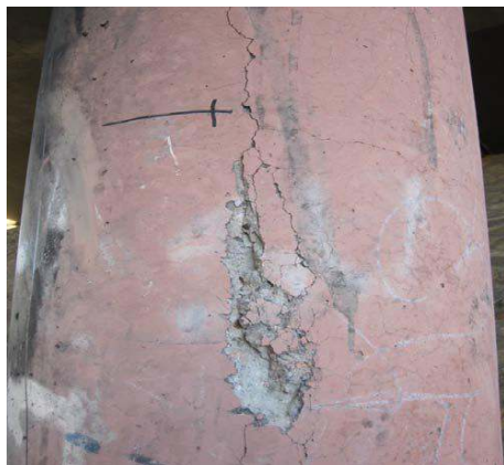
تغییر رنگ بتن، نشانگر خسارت ناشی از آتش است. ترک‌خوردگی متوسط و ضربه‌های مکرر باعث تورق شده است.
