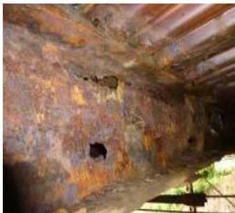
خوردگی بسیار شدید در تیر اصلی رخ داده است. قسمت اعظم مقطع تیر از بین رفته است.
