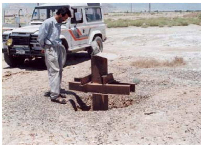
بیرون ماندن لوله جدار چاه آب (ناشی از نشست زمین در منطقه مابین شریف‌آباد و زنگی آباد)
