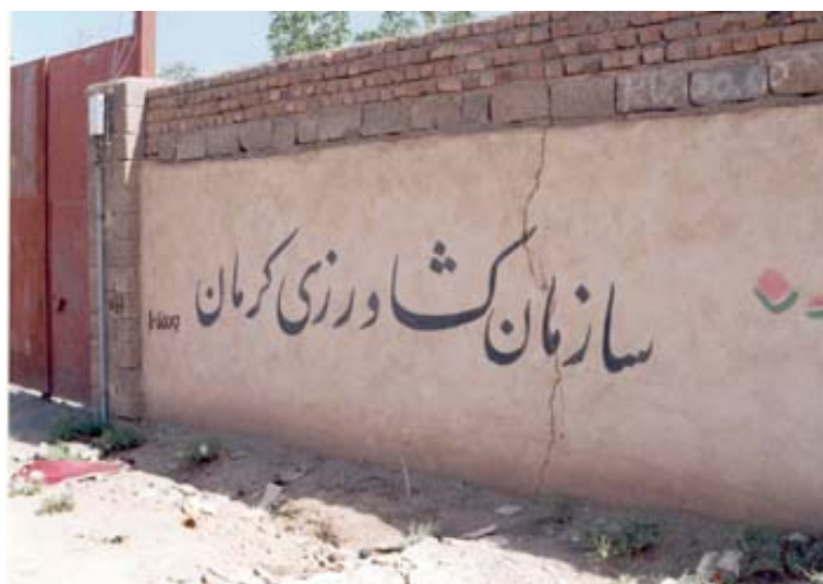
درز و شکاف ایجاد شده در دیوار یک واحد مسکونی (ناشی از نشست زمین در شریف‌آباد، ابتدای جاده زنگی آباد)
