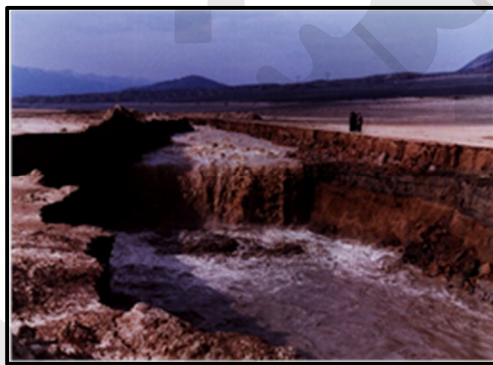
شکل ۱-۷- فرسایش پس‌رونده آبخاری در کانال فرسایشی در حین عملیات رسوبزدایی منبع: کمیته‌ی رسوب سد سفیدرود
