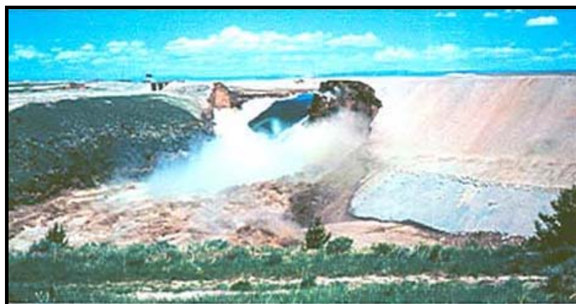
شکاف ۳-۱۴- افزایش مستمر ابعاد شکاف سد و متعاقب آن افزایش سیلاب
