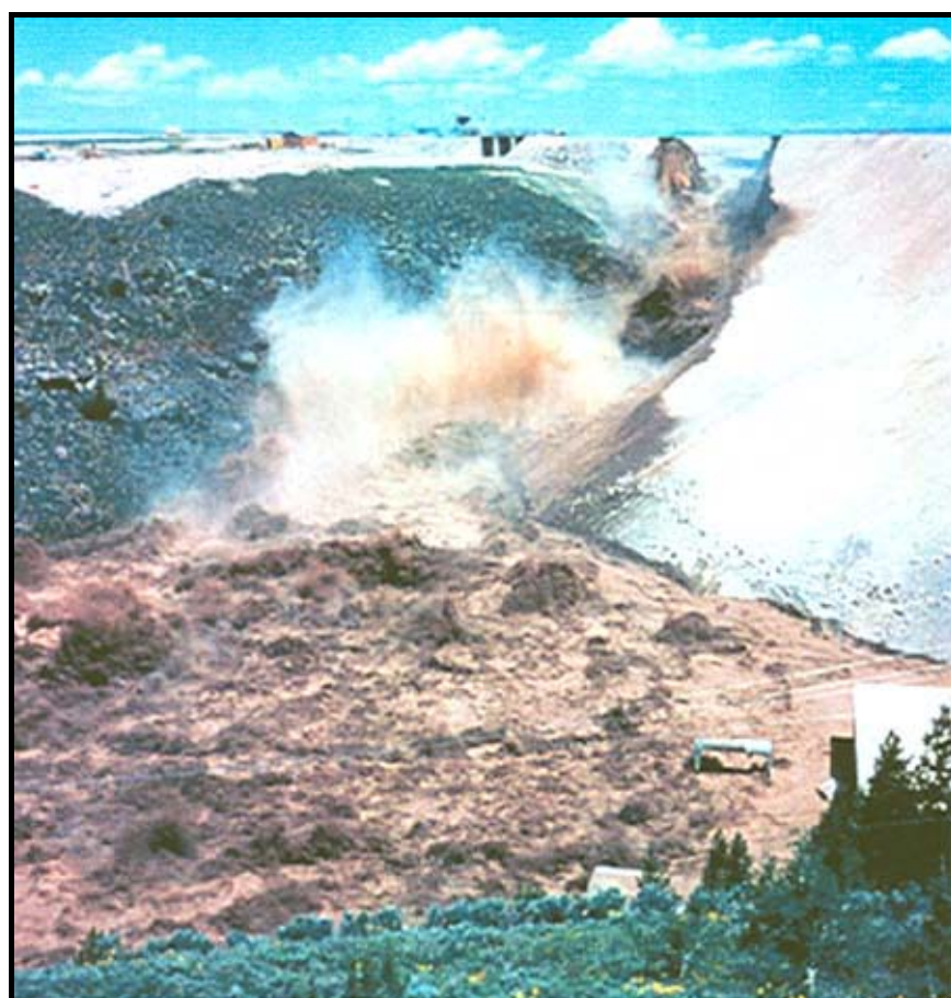
شکل ۳-۹- ایجاد شکاف در سد در ساعت ۱۱:۵۷ و ایجاد جریان سیلابی گل آلود شدید
