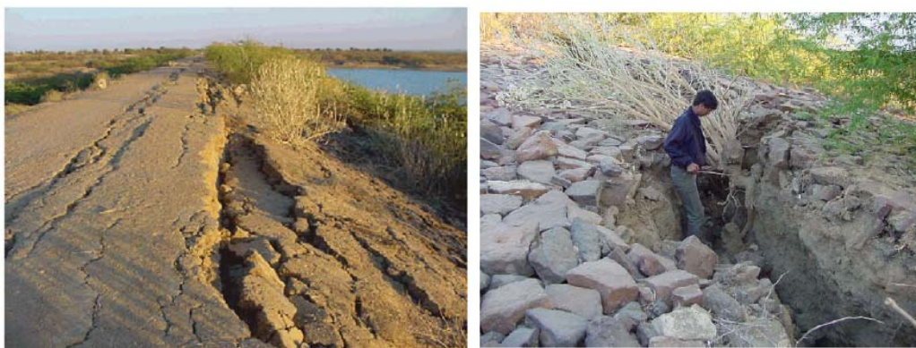
شکل ۲-۲ ترک طولی ناشی از لغزش شیب در بالادست یک سد خاکی در زلزله بیهاج هند
