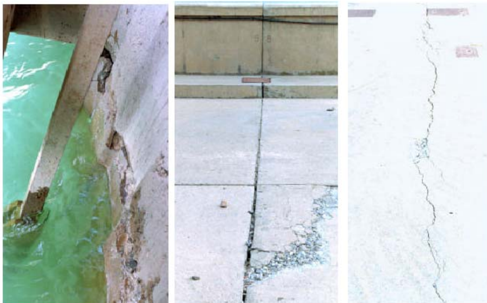
شکل ۲-۶ ترک‌های روی تاج سد سفید رود (راست) و ترک‌های ایجاد شده در روی وجه بالادست سد سفیدرود (چپ) در اثر زلزله ۱۳۶۹ منجیل
