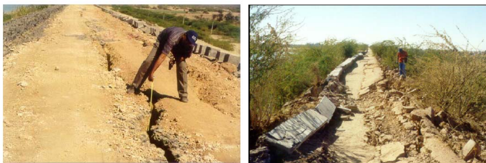
شکل ۲-۳ ترک طولی و نشست در روی تاج سد Suvi در اثر زلزله بیهاج سال ۲۰۰۱
