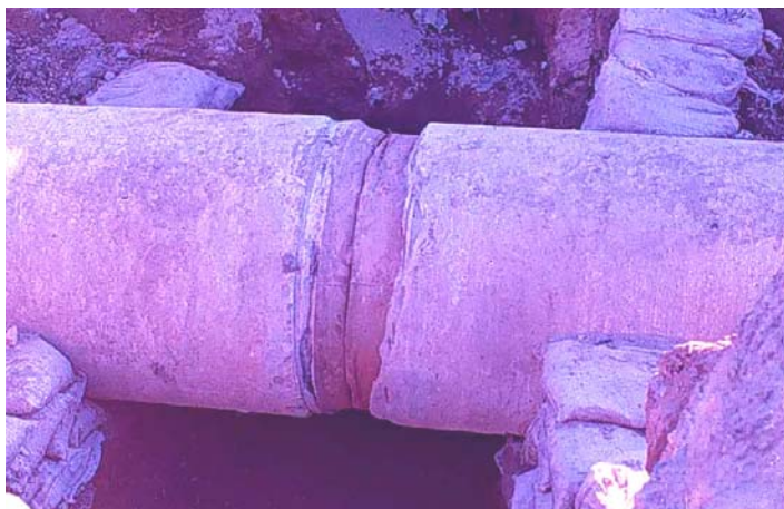
شکل ۲-۱۵ شکستگی لوله و اتصال آن در زلزله مکزیکو سیتی در سال ۱۹۸۵
